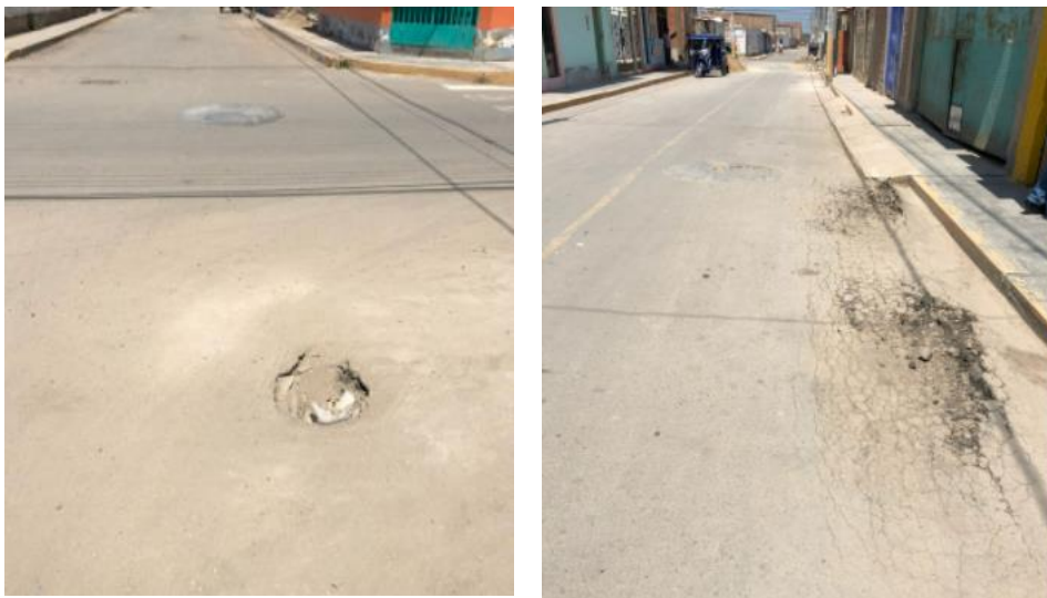
Figura 3. Pavimentación en malas condiciones
