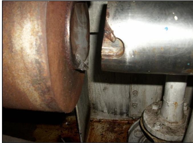
Figura 12 Rotura de la unión con la brida
