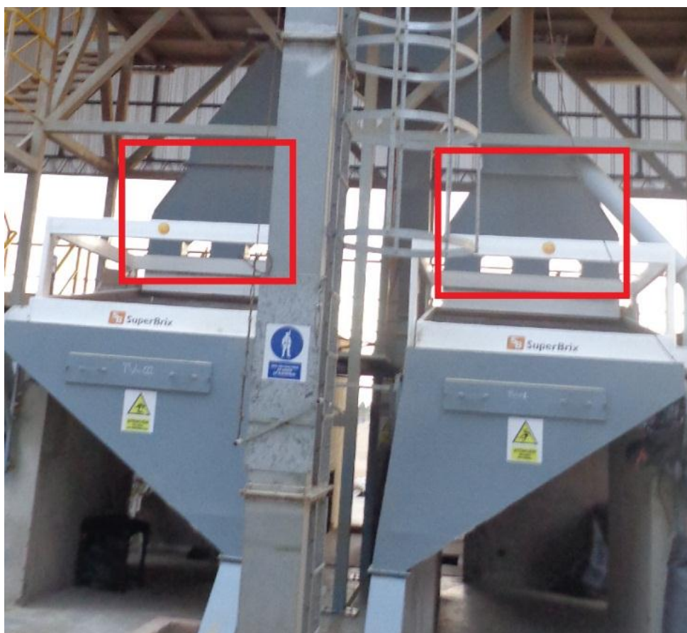
Figura 13: Estructura de Tolvas de Zarandas
