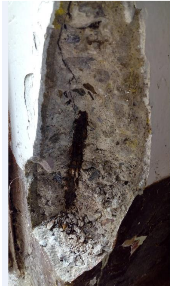
Fig. 13. Columna en mal estado tomada en cuenta para índice T
