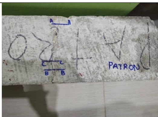
Figura 128: Viga patrón fisurada, antes.
