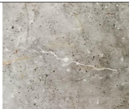
Figura 2: La misma grieta después de 3 semanas.
