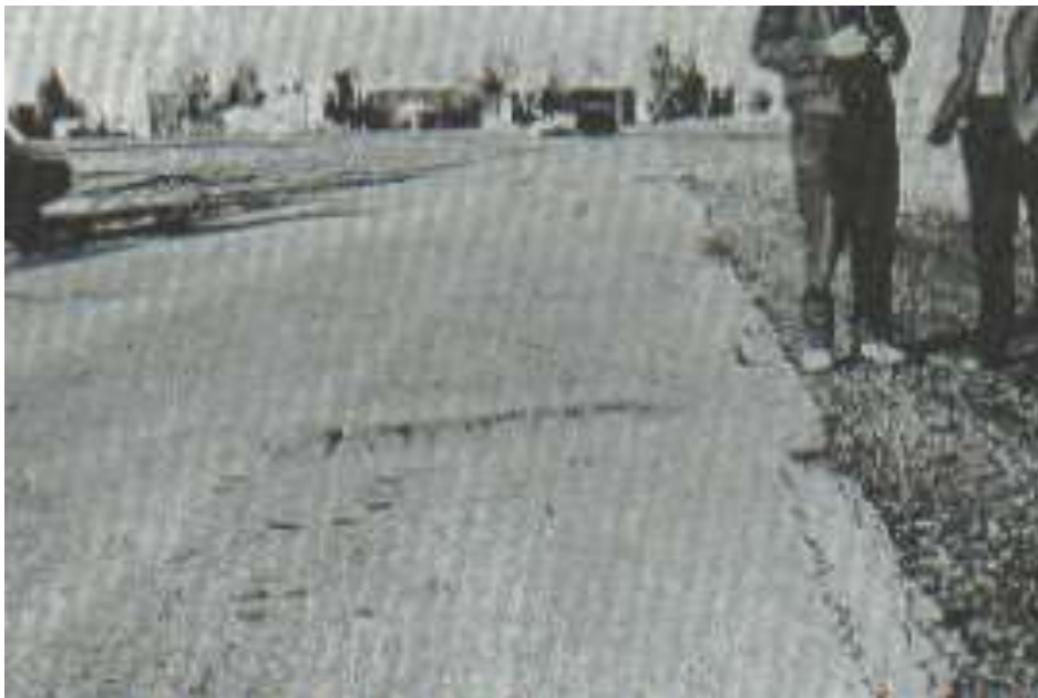
Figura 8 Abultamiento y hundimiento
