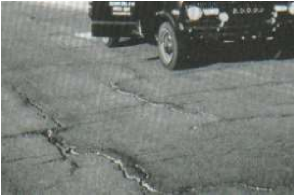
Figura 7 Agrietamiento en bloque
