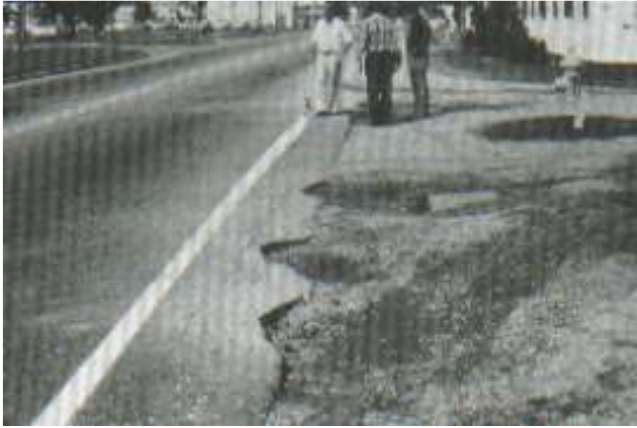
Figura 11 Grietas de borde
