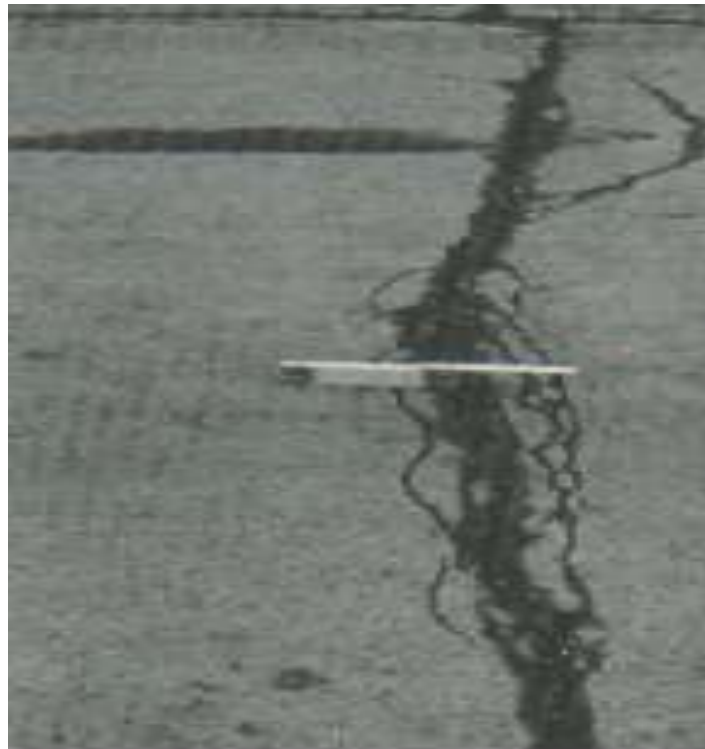
Figura 12 Grieta de reflexión de junta
