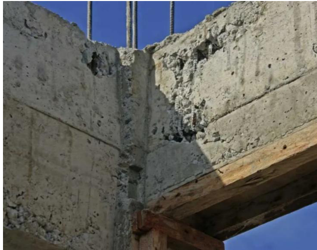
Gráfico 5: Segregación de concreto
