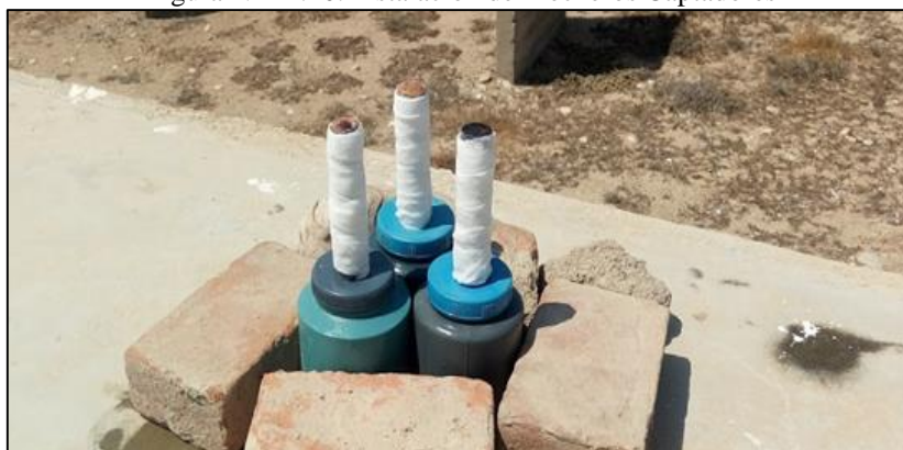
Figura N° III.10. Instalación de Mecheros Captadores
