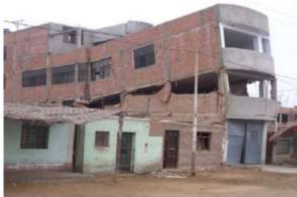
FIGURA N° 18: Falla estructural y Hundimiento en la Ciudad de Ica
