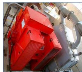
Generador de la Central
