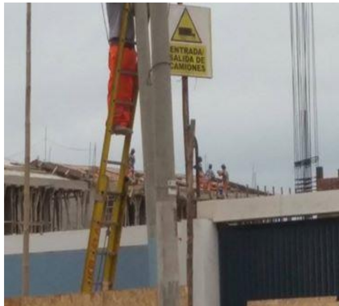
igura 11. Trabajador en riesgo expuesto
