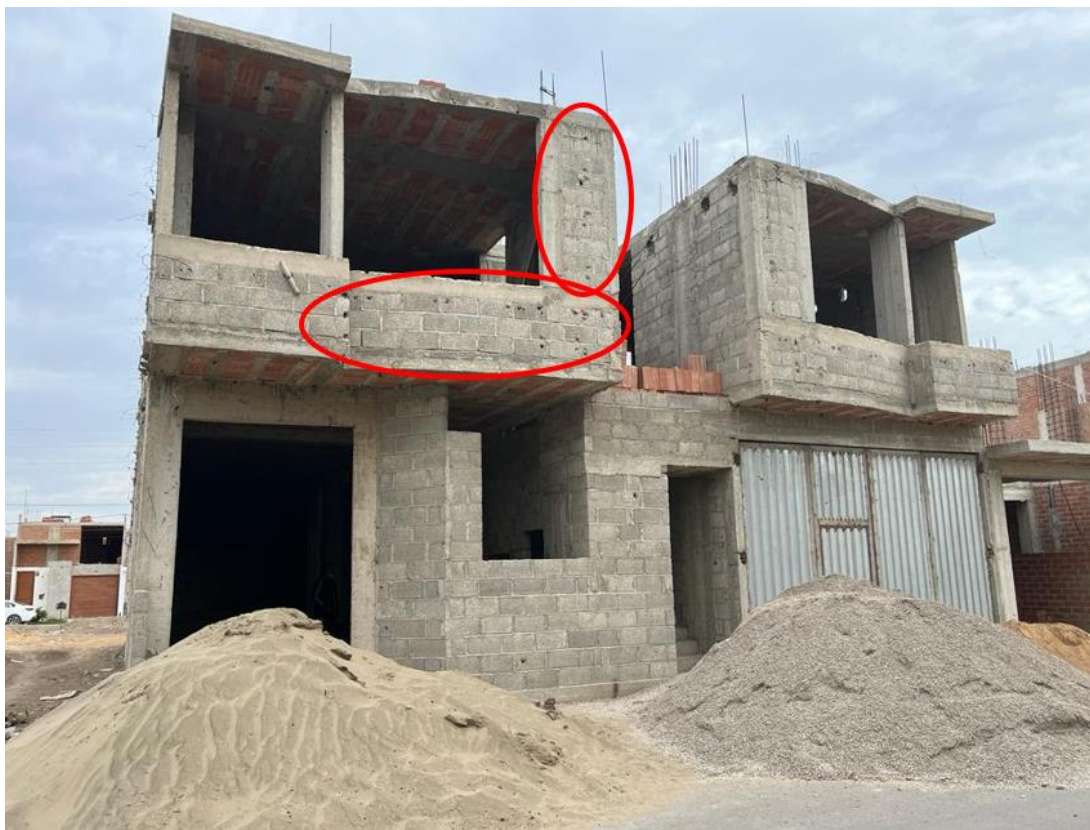
Figura 27. Deficiencias de bloques de concreto en viviendas de la ciudad de Chiclayo
