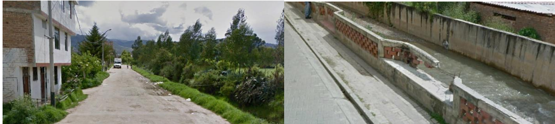
(Deterioro y falta de tratamiento de infraestructura urbana)
