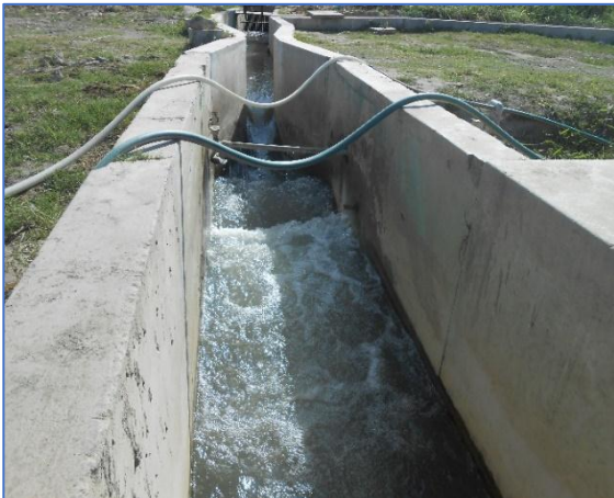
3. Canal parshall mezclado sulfato de aluminio
