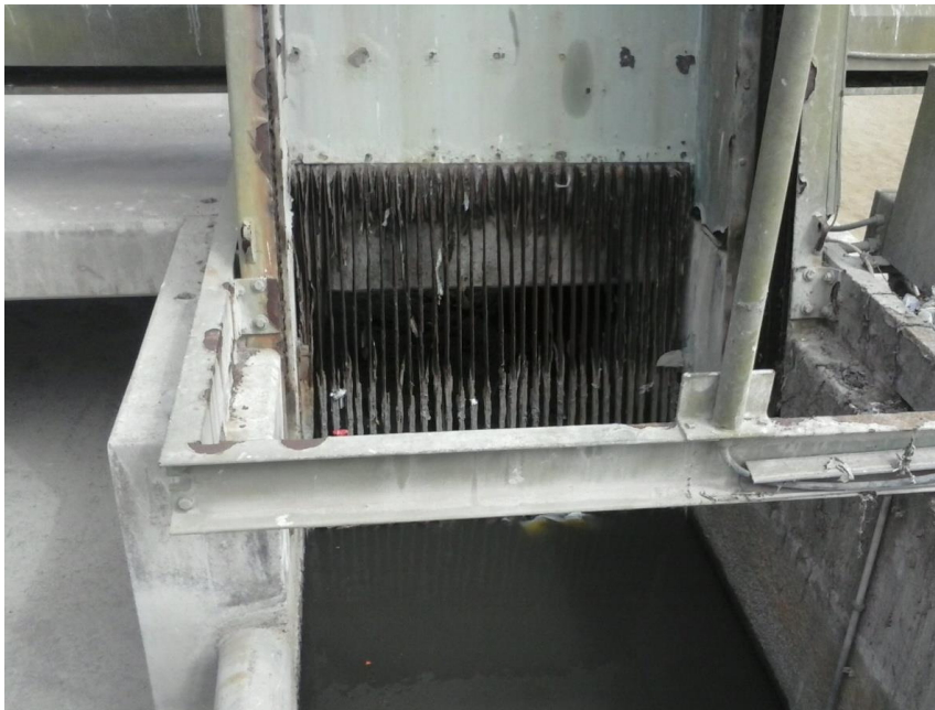
ANEXO 4. Cámara de rejas parte inferior
