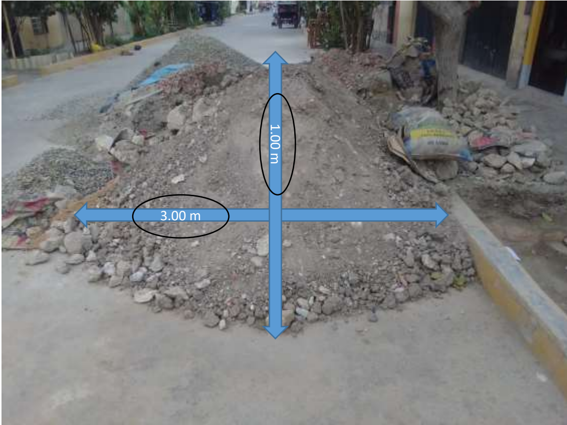
Figura 14 Material encontrado en la obra 01
