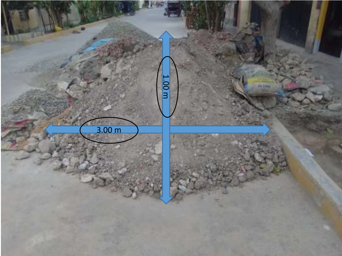
Figura 91 Material encontrado en la obra 01
