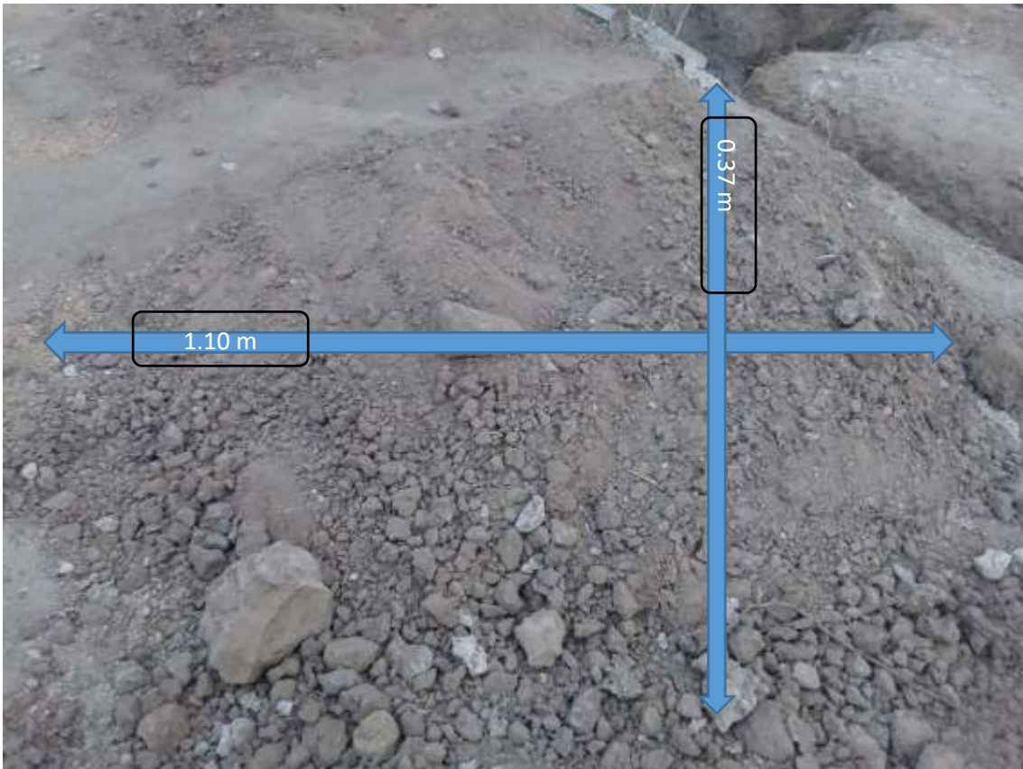
Figura 31 Desmorte encontrado en la obra 03
