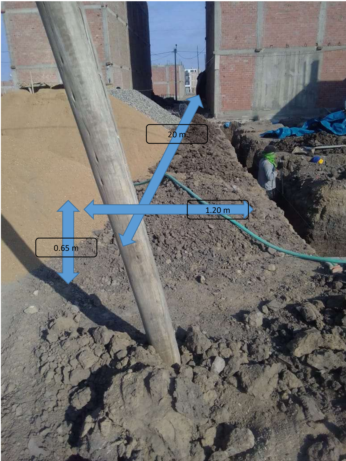
Figura 125 desmonte encontrado en la obra 06
