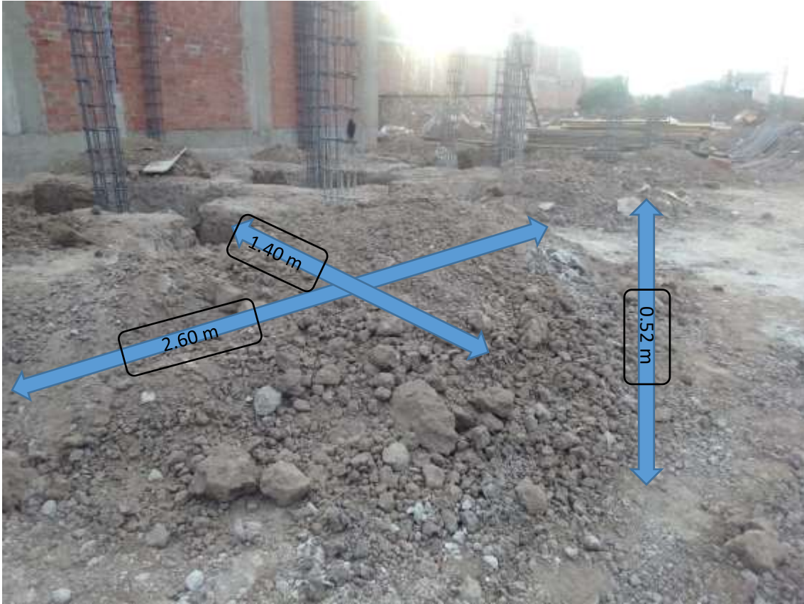
Figura 106 Desmonte encontrado en la obra 03
