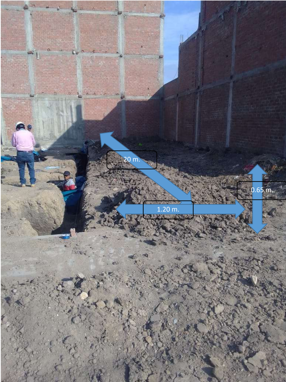
Figura 49 desmonte encontrado en la obra 06
