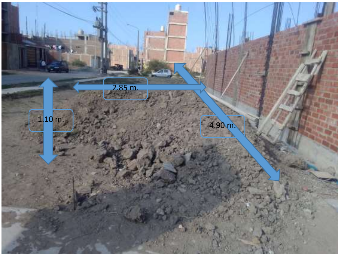
Figura 42 Ubicación de los residuos de la obra 05
