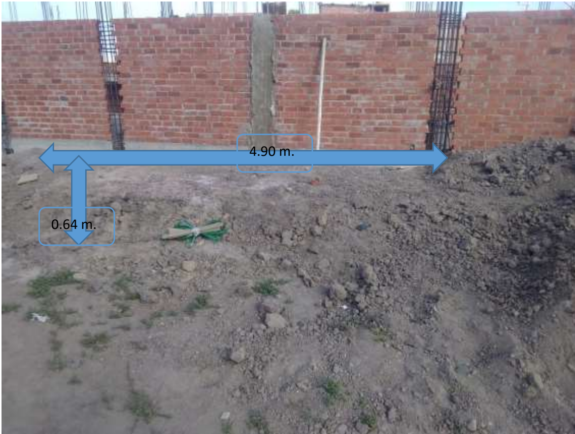
Figura 43 desmonte encontrado en la obra 05
