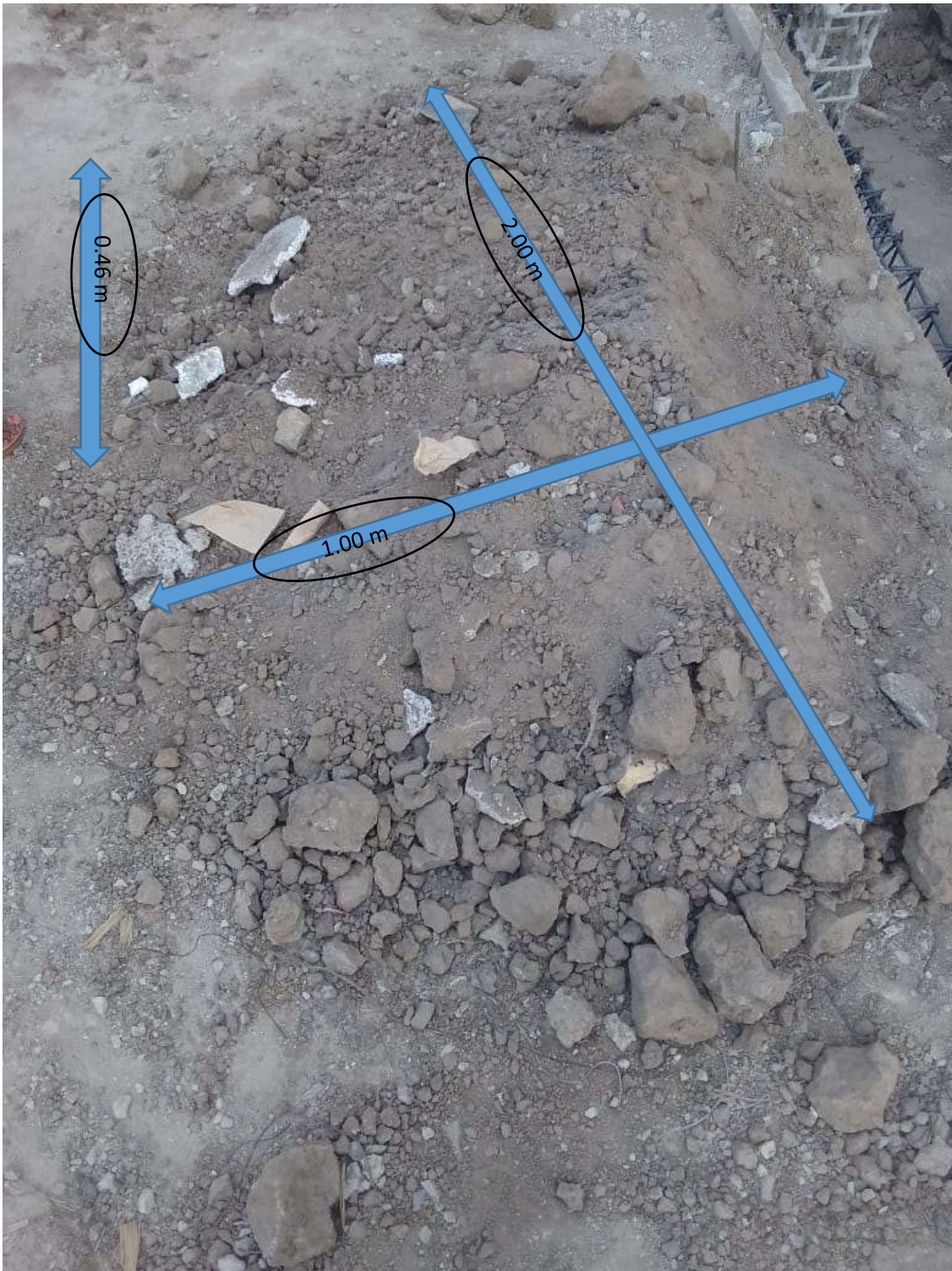
Figura 105 Desmonte encontrado en la obra 03
