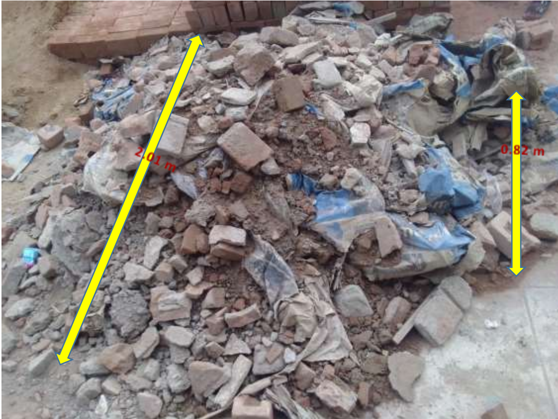
Figura 20 Ubicación de los residuos de la obra 02
