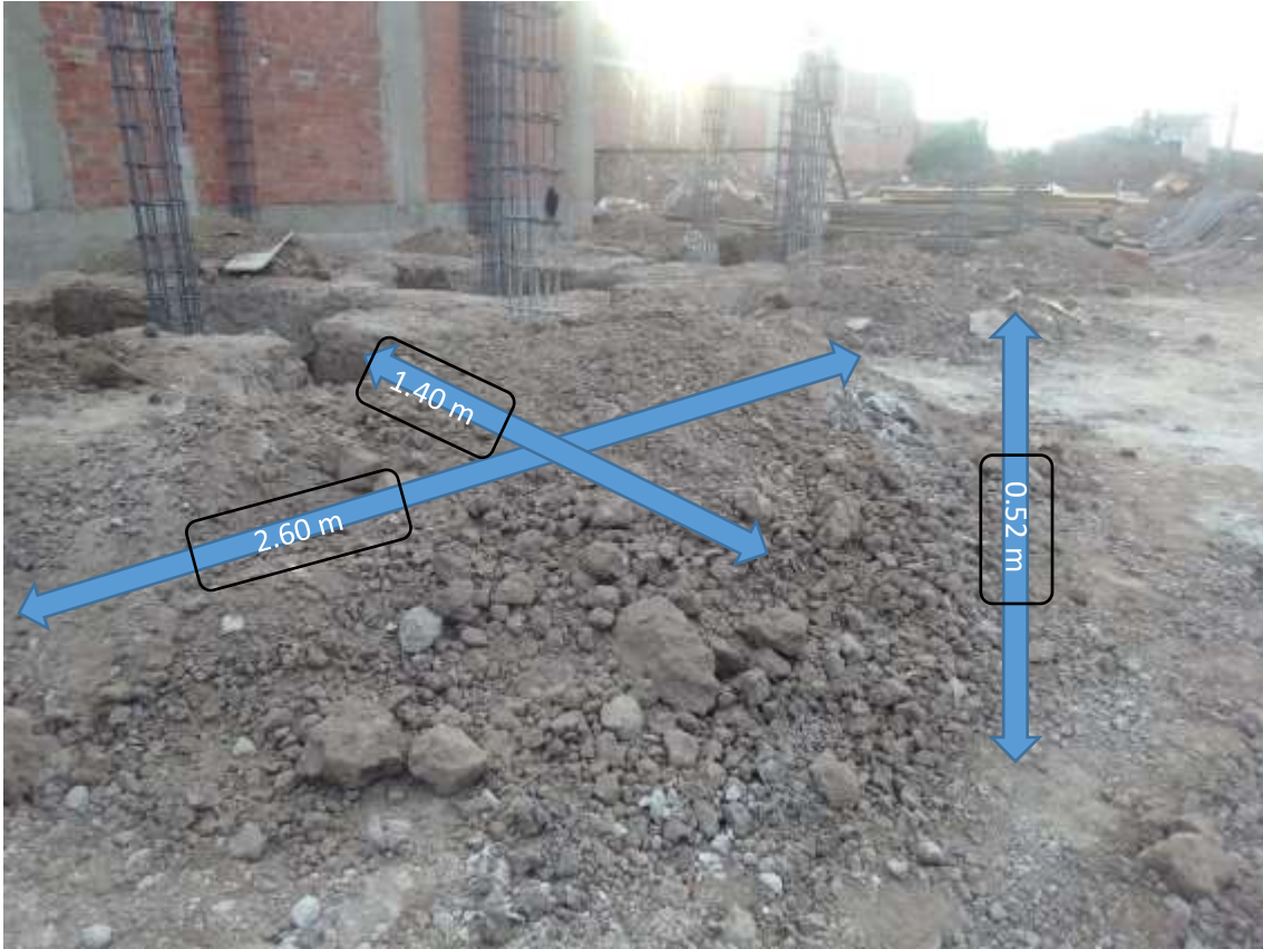
Figura 29 Desmonte encontrado en la obra 03
