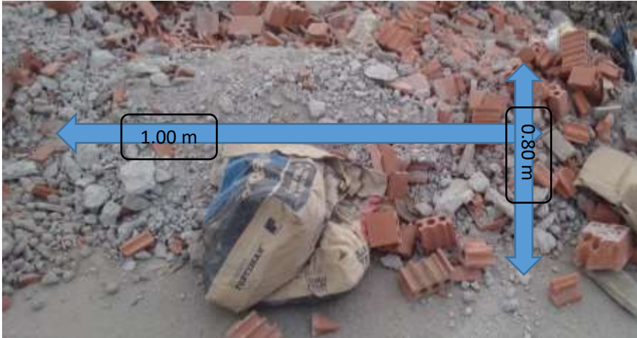
Figura 111 Residuos encontrados en la obra 03
