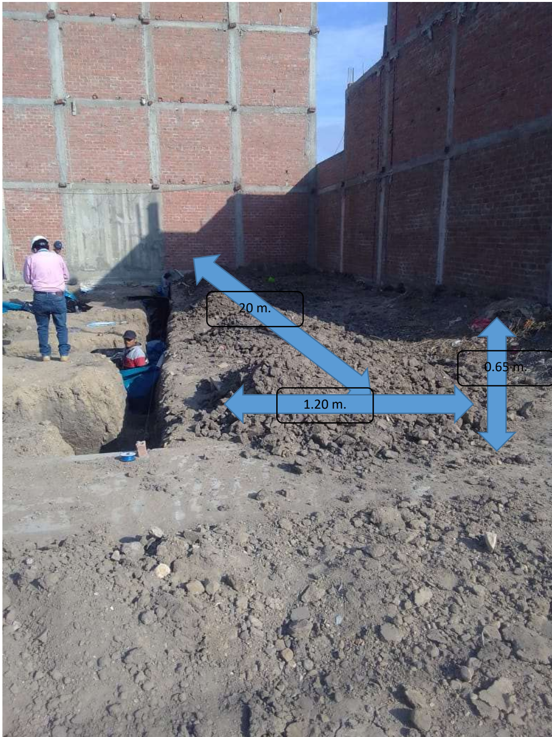
Figura 126 desmonte encontrado en la obra 06
