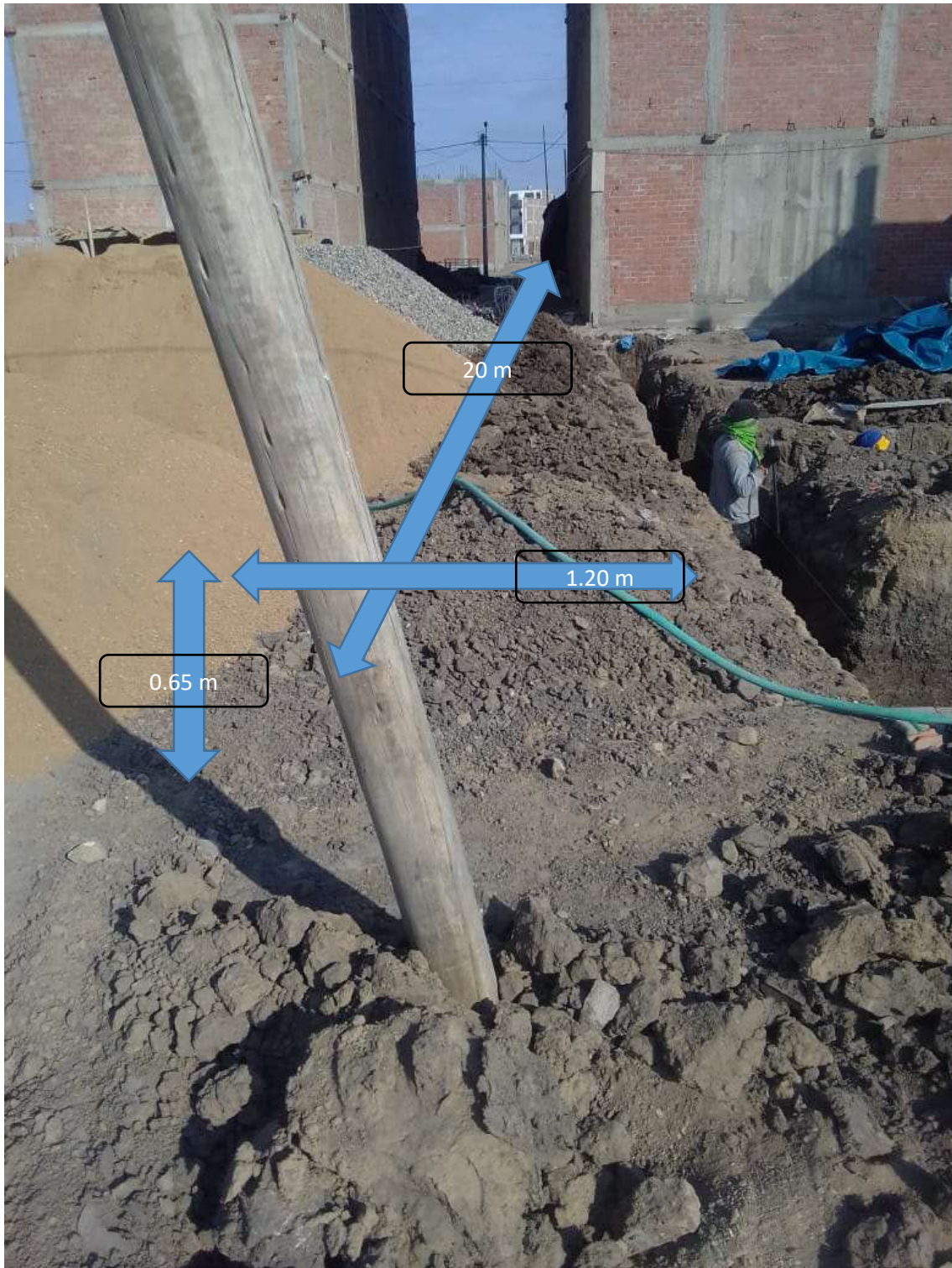
Figura 48 desmonte encontrado en la obra 06
