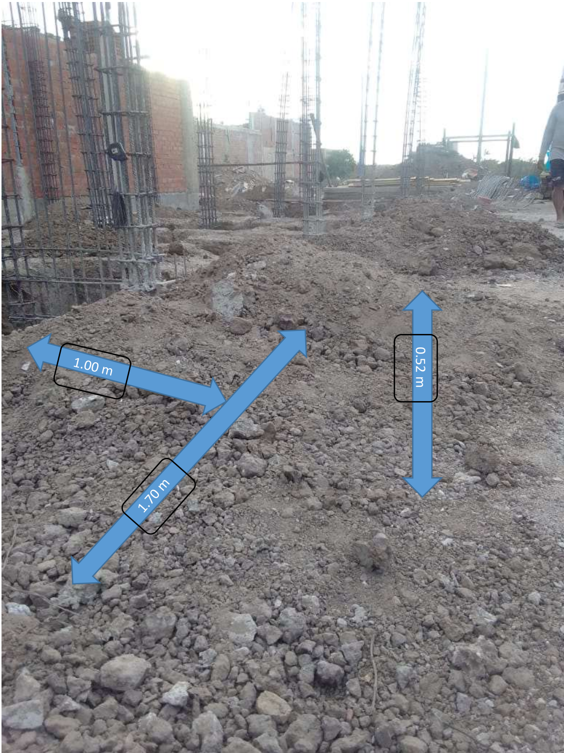
Figura 30 Desmonte encontrado en la obra 03
