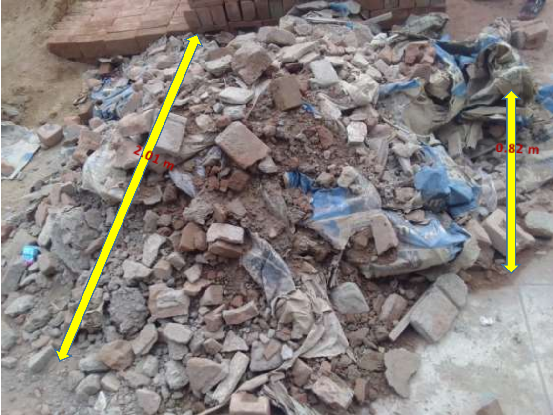
Figura 97 Ubicación de los residuos de la obra 02
