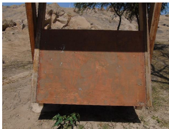
Imagen 30: Panel informativo quemado. Fuente: propia.
