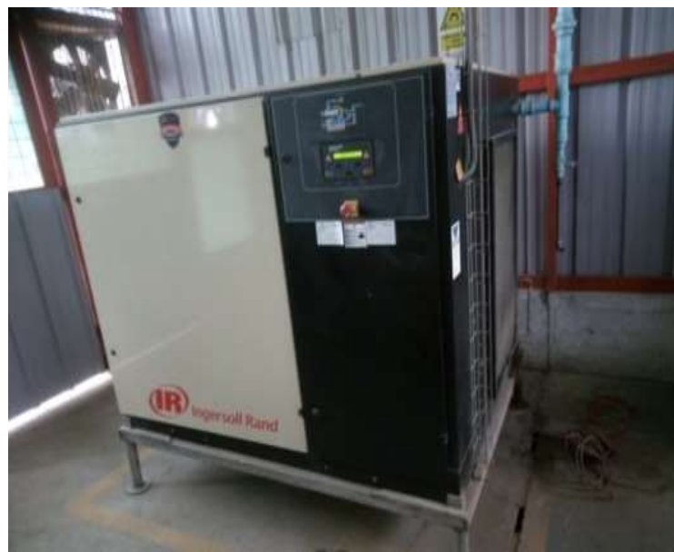
Figura 57. Compresor de tornillo.
