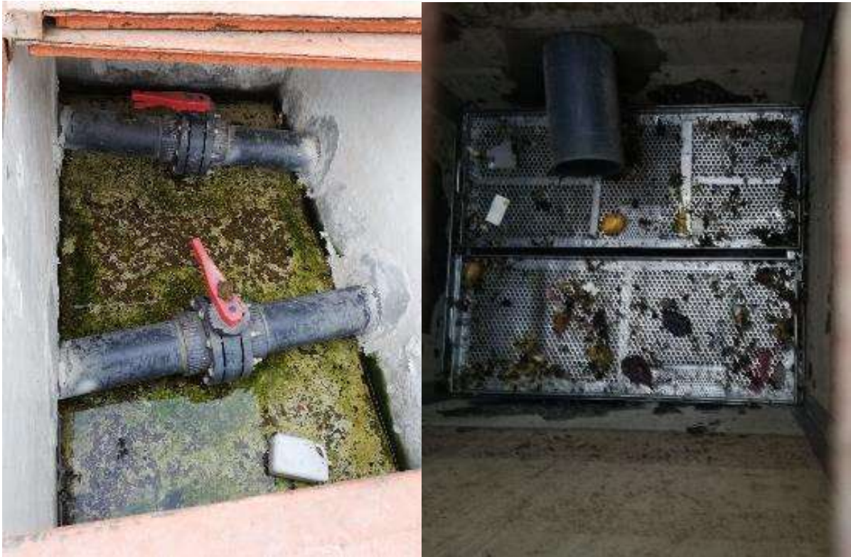
Figura 30. Caja de válvulas mecánicas y sistema de rejilla de filtros.
