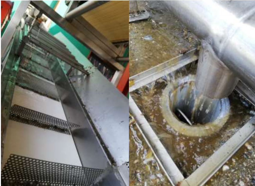
Figura 14. Desinfección de fruta por ducha y desemboque de agua residual. Fuente: Quicornac SAC
