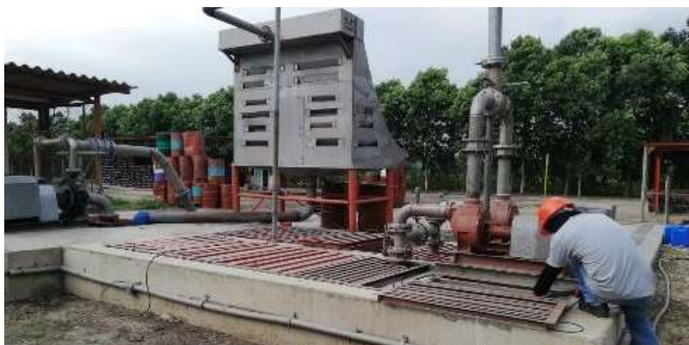
Figura 26. Sistema de tratamiento preliminar de las aguas residuales
