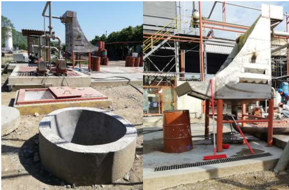
Figura 31. Pozo de encuentro y filtro estático.
