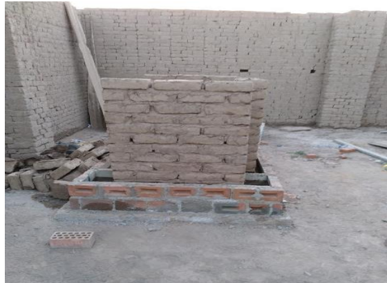
Fig. 99. Ensayo de Inundación Simulada. Muro colapsado de SP estabilizado al 9% al cabo de 5 horas de iniciar el ensayo.
