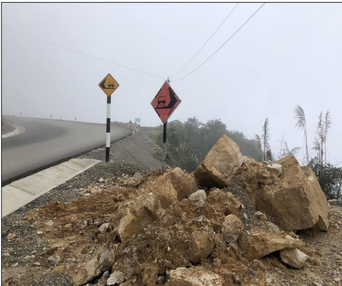
Figura 18. Señalización informativa de desprendimiento de rocas existente.
