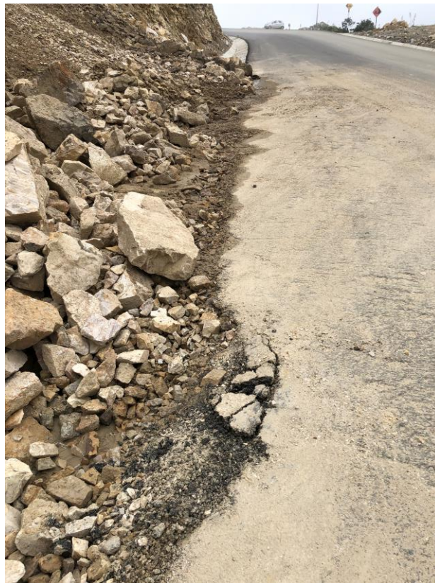
IMÁGEN N°3.6: Deterioro del pavimento por la constante caída de rocas.
