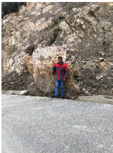
Figura 21. Roca de un volumen de 3.90m3 en el tramo evaluado Km 46+300 – Km 46+350.
