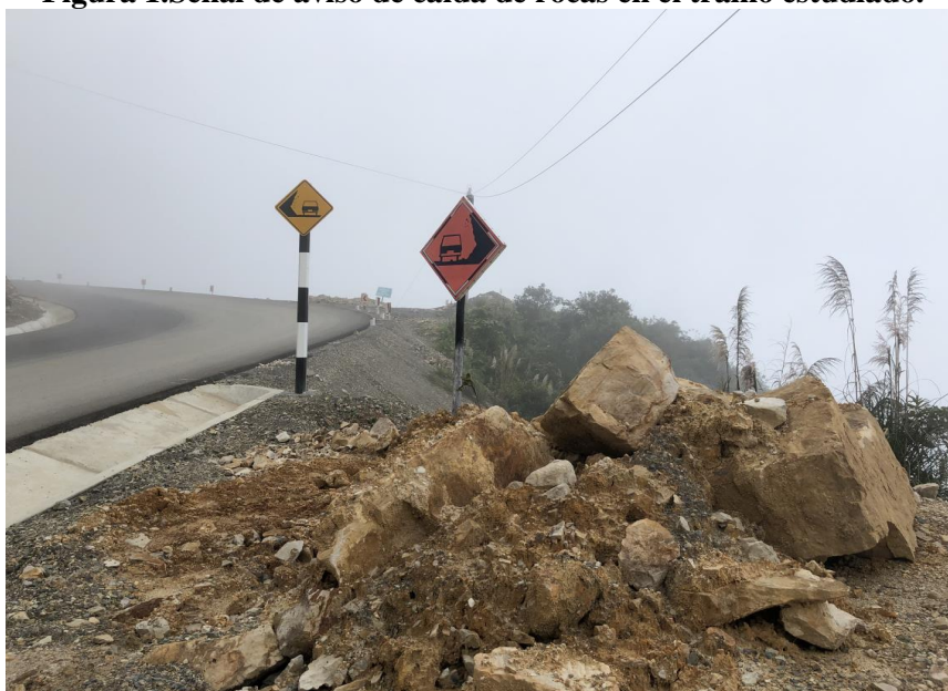
Figura 1. Señal de aviso de caída de rocas en el tramo estudiado.
