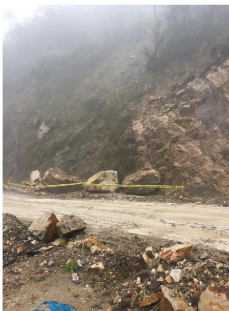
Figura 5. Caída de rocas carretera Cutervo- Chiple.
