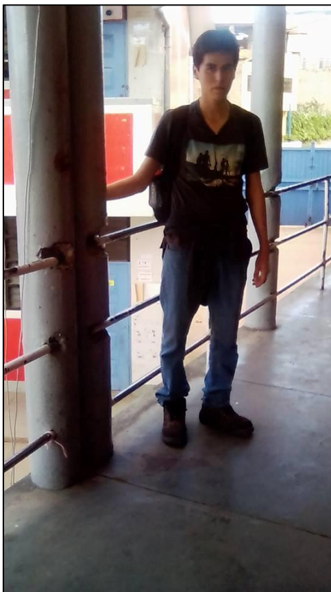
FOTOGRAFÍA N°4.11: BARANDAS DE LA INSTITUCIÓN EMPOTRADAS A LA COLUMNA
