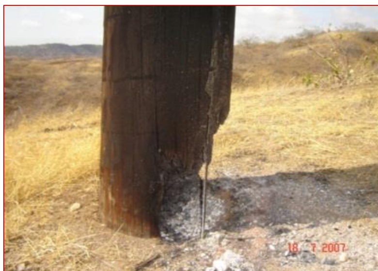
Figura 4. 3. Poste de madera deteriorado por cambios climatológicos. Fuente: Gerencia de Operación y Mantenimiento. Red de Energía del Perú S.A.
