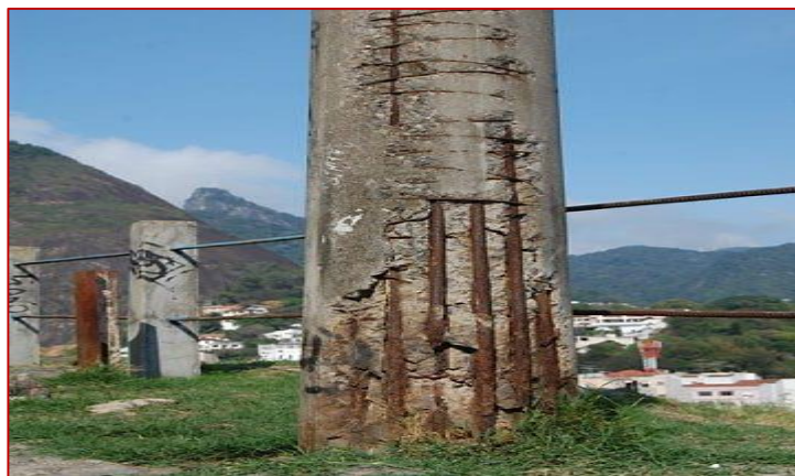
Figura 4. 1. Poste de Concreto Armado centrifugado en mal estado Fuente: www.skyscrapercity.com
