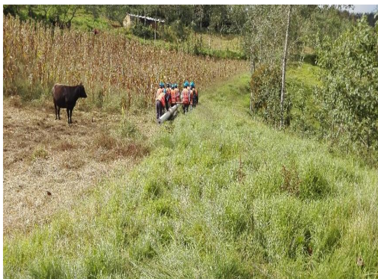
Figura 4. 13. Traslado de postes a su punto de izado. Fuente: Proyecto Eléctrico - Instalación del sistema de energía eléctrica en el caserío Lirio Chico, distrito y provincia de Cutervo – Cajamarca.
