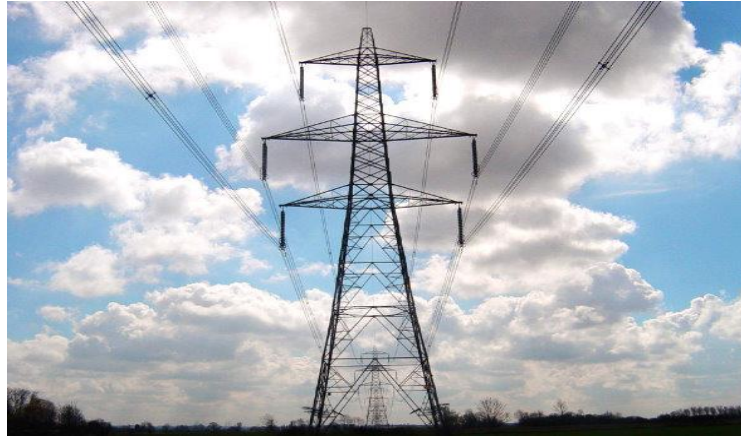
Figura 4. 2. Torres de celosía con acero galvanizado. Fuente: www.estructuraslago.com/trabajos/1/
