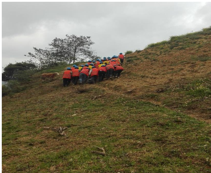
Figura 4. 19. Traslado de postes a su punto de izado, inexistencia de caminos. Fuente: Proyecto: Ampliación del servicio de energía rural en la comunidad de Chugur, distrito y provincia de Cutervo - Cajamarca.
