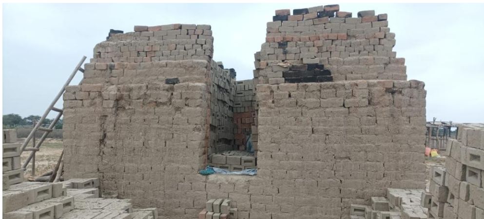
Figura 38. Verificación de horno adecuado.
