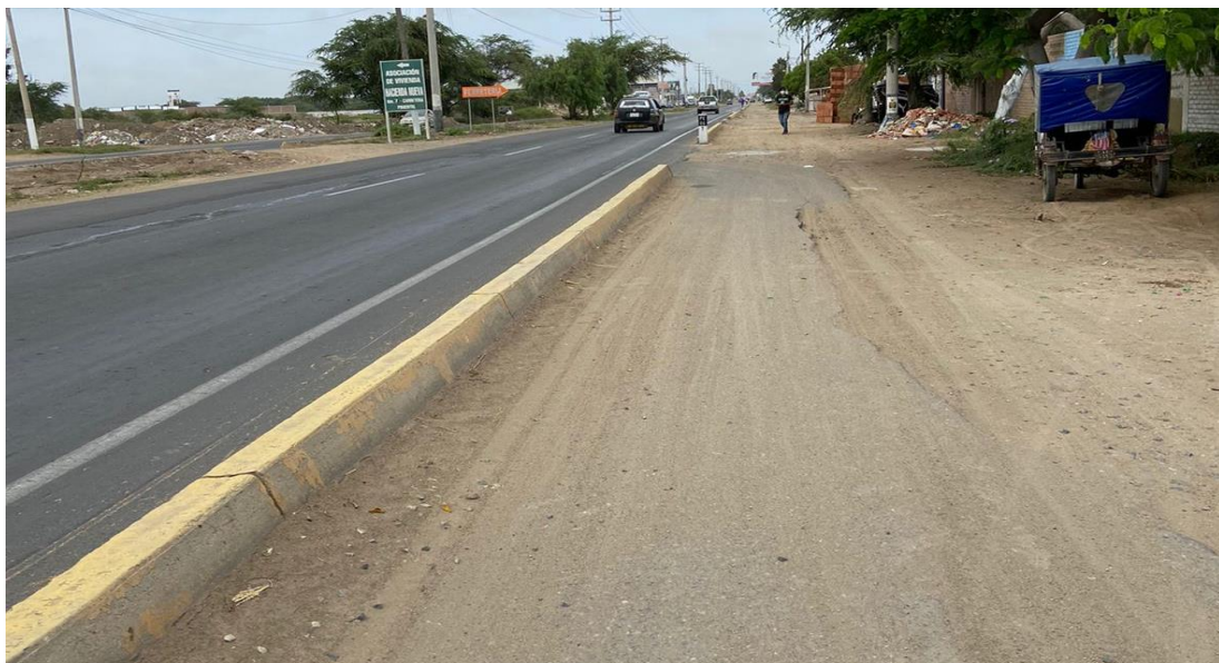
Ilustración 64 - Inicio de la ciclovía km-7, pavimento deteriorado - (Fuente Propia).
