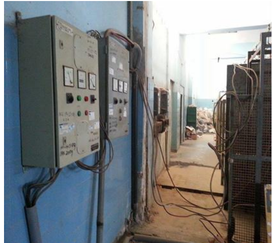
Figura N° 69. Tablero eléctrico Fuente: Gerencia operacional EPSEL S.A.
