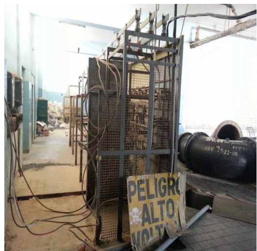
Figura N° 70. Estación de generación Fuente: Gerencia operacional EPSEL S.A.
