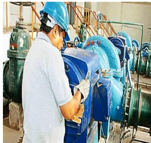
Figura N° 71. Avería de bomba Fuente: Gerencia operacional EPSEL S.A.
