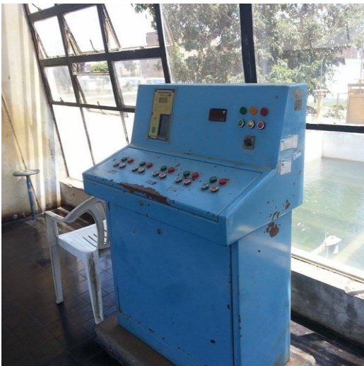
Figura N° 67. Tablero de mando PTAP N°1 Fuente: Gerencia operacional EPSEL S.A.
