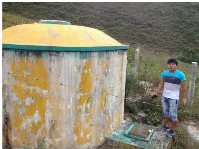
FOTOGRAFÍA N° 18: Reservorio Existente en el Sector Miraflores (V=30 m 3 )
