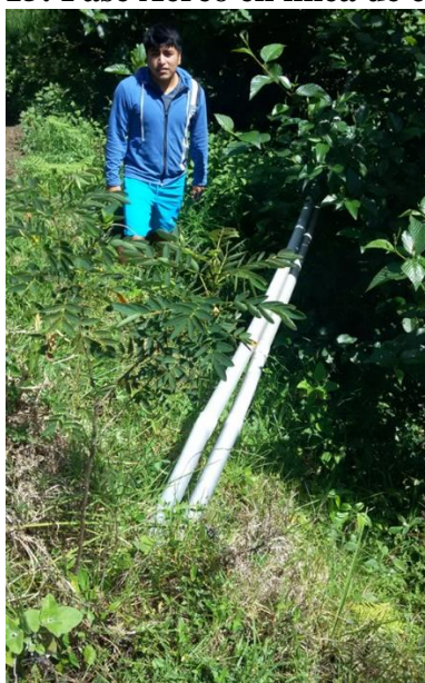
FOTOGRAFÍA N° 15: Pase Aéreo en línea de conducción La Racra
