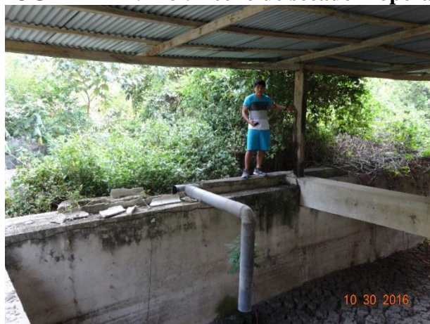
FOTOGRAFÍA N° 28 : Lecho de secado inoperativo.
