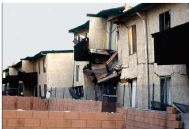
Ilustración 30 Edificios colapsados a causa del terremoto de Northridge en 1994
