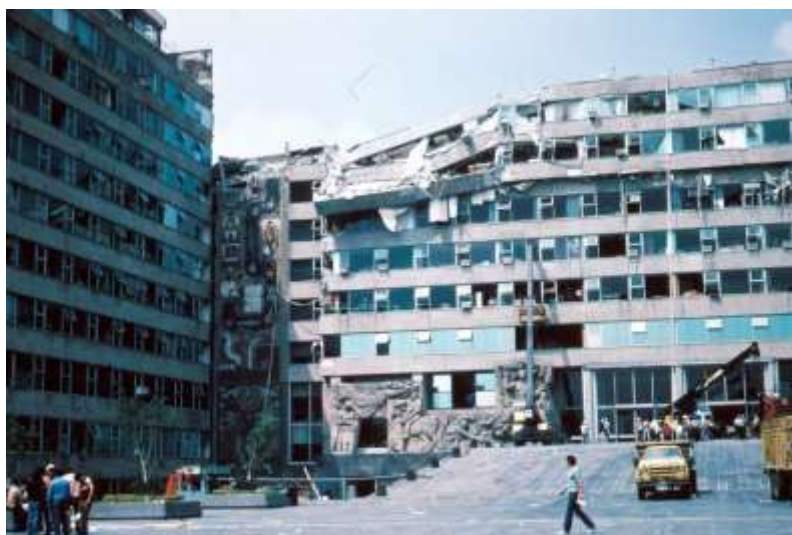
Ilustración 20 Daño ocasionado por irregularidad de esquina entrante
