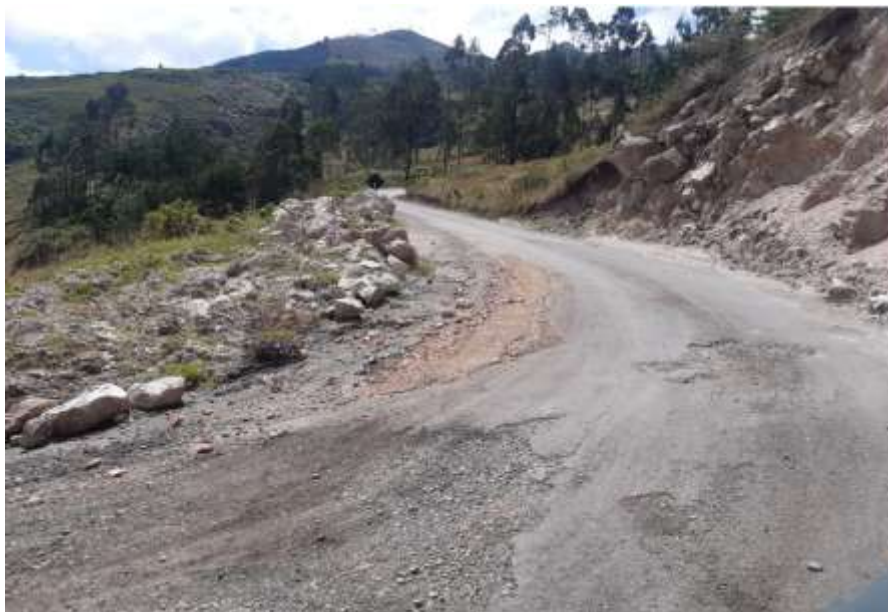
Ilustración 4: Estado actual de la carretera tramo Marampampa - Culdén.
