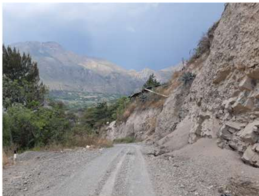
Ilustración 5: Estado actual de la carretera tramo Catache - Marampampa.
