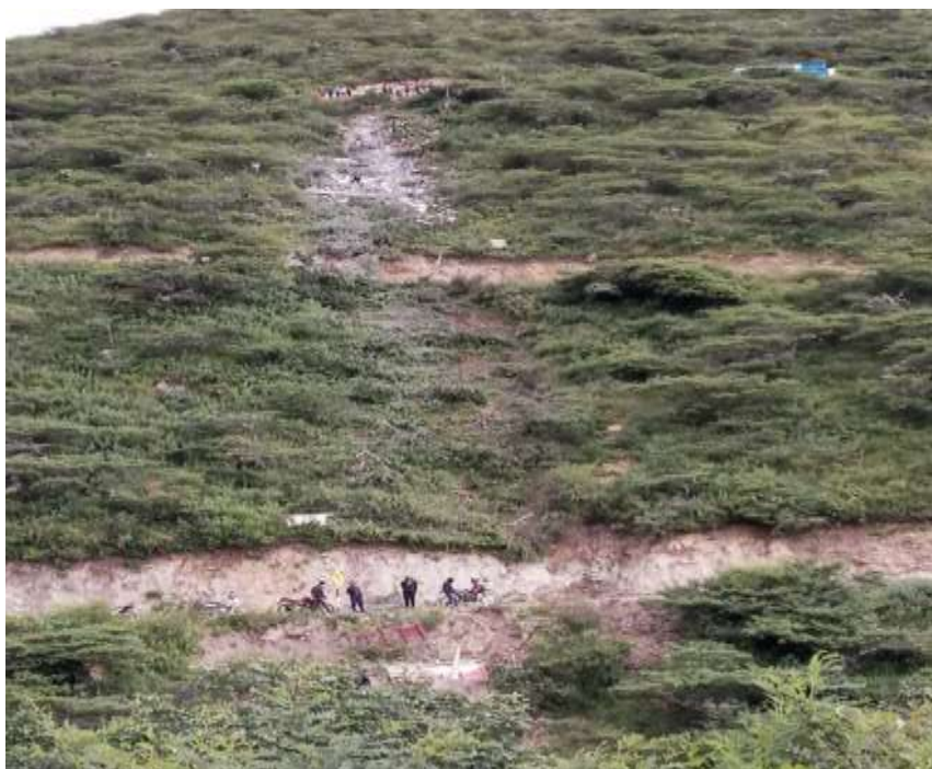
Ilustración 7: Accidente ocurrido en la carretera tramo Catache - Marampampa.
