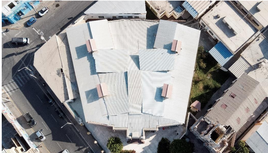
Imagen 15. Vista área del Pabellón Luis Gonzales, presencia de calaminas en cubiertas.
