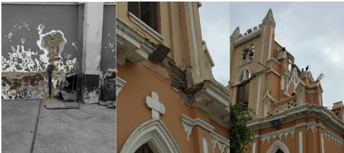
Imagen 10. Fotos de lesiones en la Capilla la Merced. Fuente propia
