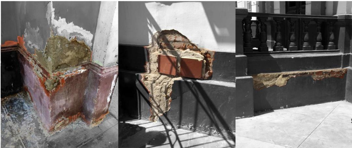
Imagen 09. Fotos de lesiones en muros. Fuente propia
