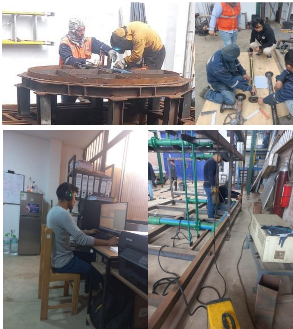
Figura 3. Desuso de los EPP, Mobiliario de Oficinas y Cables Expuestos
