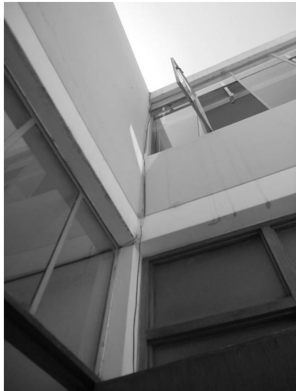
Imagen N° 292. Encuentro de cubierta con carpintería de madera. Fuente: Propia
