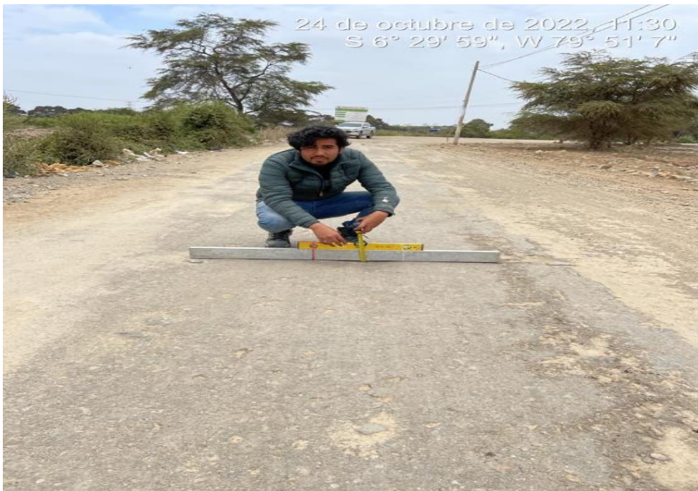
Ilustración 162: Presencia de ahuellamiento de aproximadamente 2 cm y disgregamiento
