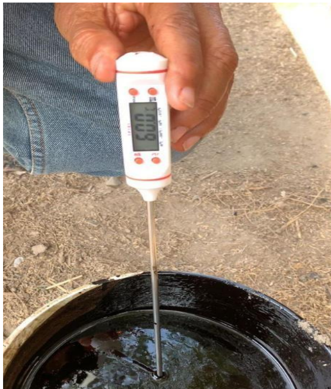
Anexo N°02.144: Medición de la temperatura del MC-30 tras ser calentado por la cocina asfáltica
