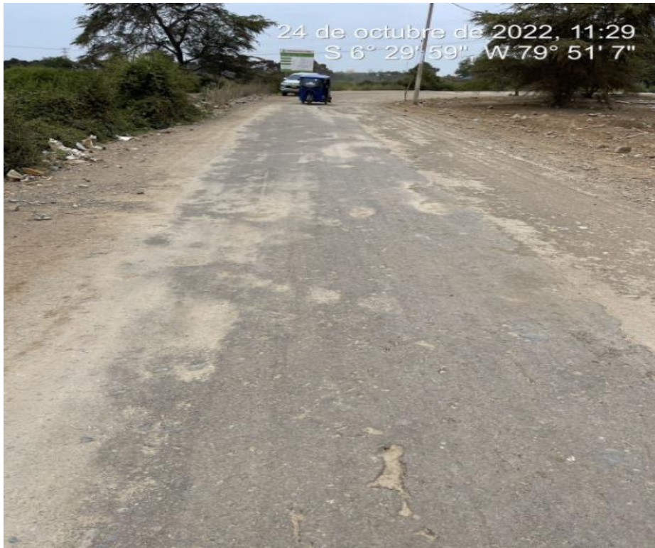
Ilustración 163: Peladuras y pérdida del revestimiento asfáltico
