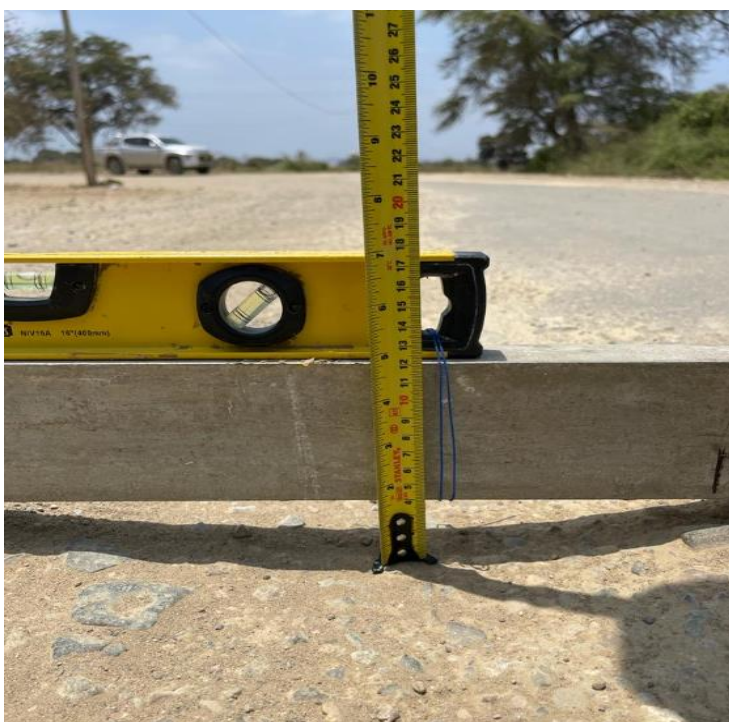
Anexo N°02.160: Presencia de ahuellamiento con baja severidad (4cm)
