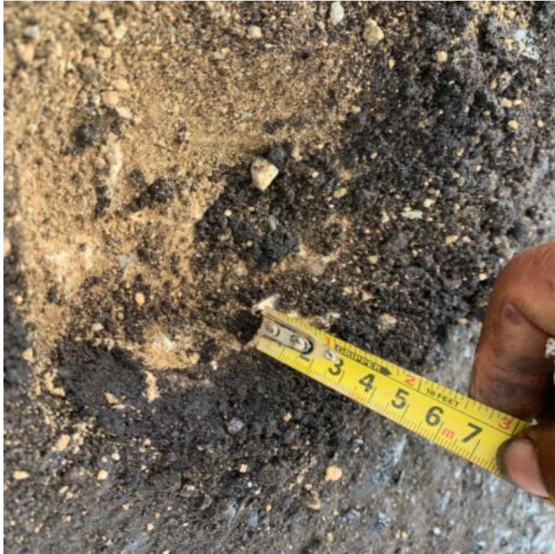
Anexo N°02.154: Penetración 36 mm, progresiva 0+140km
