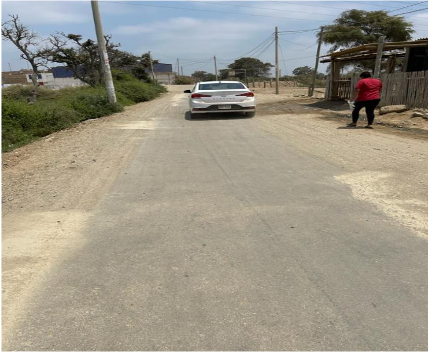
Anexo N°02.160: Desprendimiento o disgregamiento con severidad alta de la imprimación reforzada con emulsión asfáltica CSS-1h
