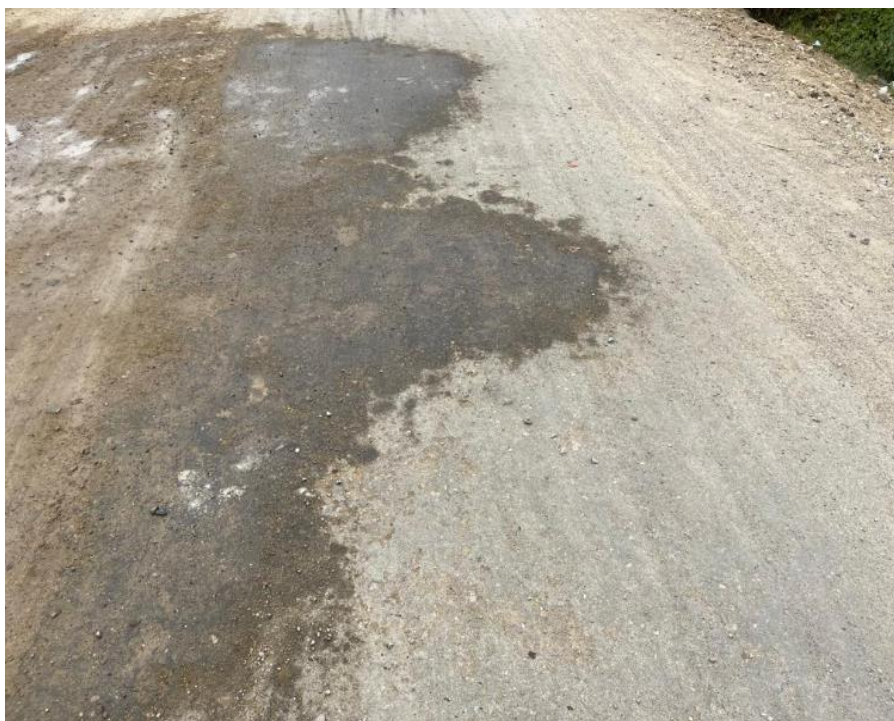
Anexo N°02.160: Humedecimiento de la vía por parte de la población
