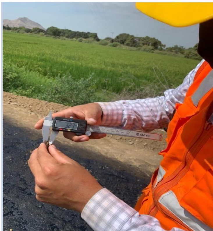
Ilustración 98: Penetración de 3.23mm, progresiva 0+030
