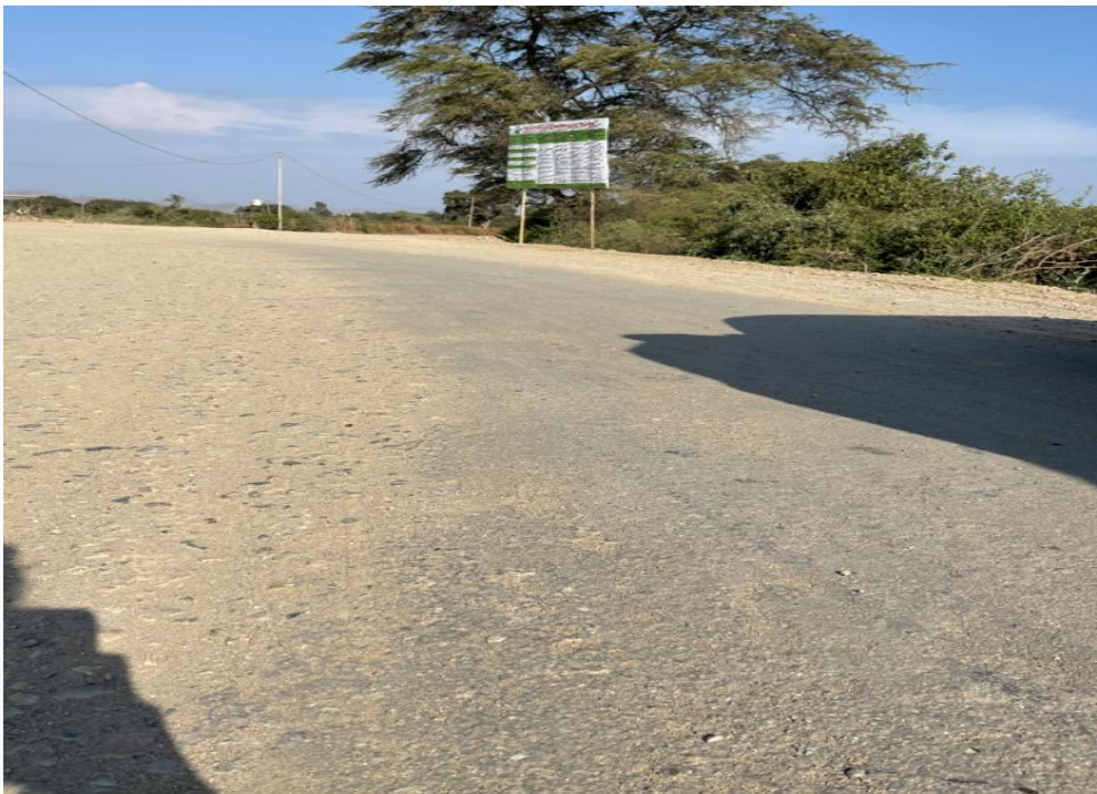
Ilustración 154: Peladuras, disgregación del árido pétreo y fino por carencia de afinidad físico-química y presencia de ahuellamiento
