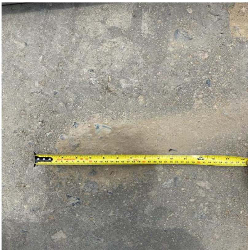
Ilustración 152: Presencia de pequeños baches con severidad baja
