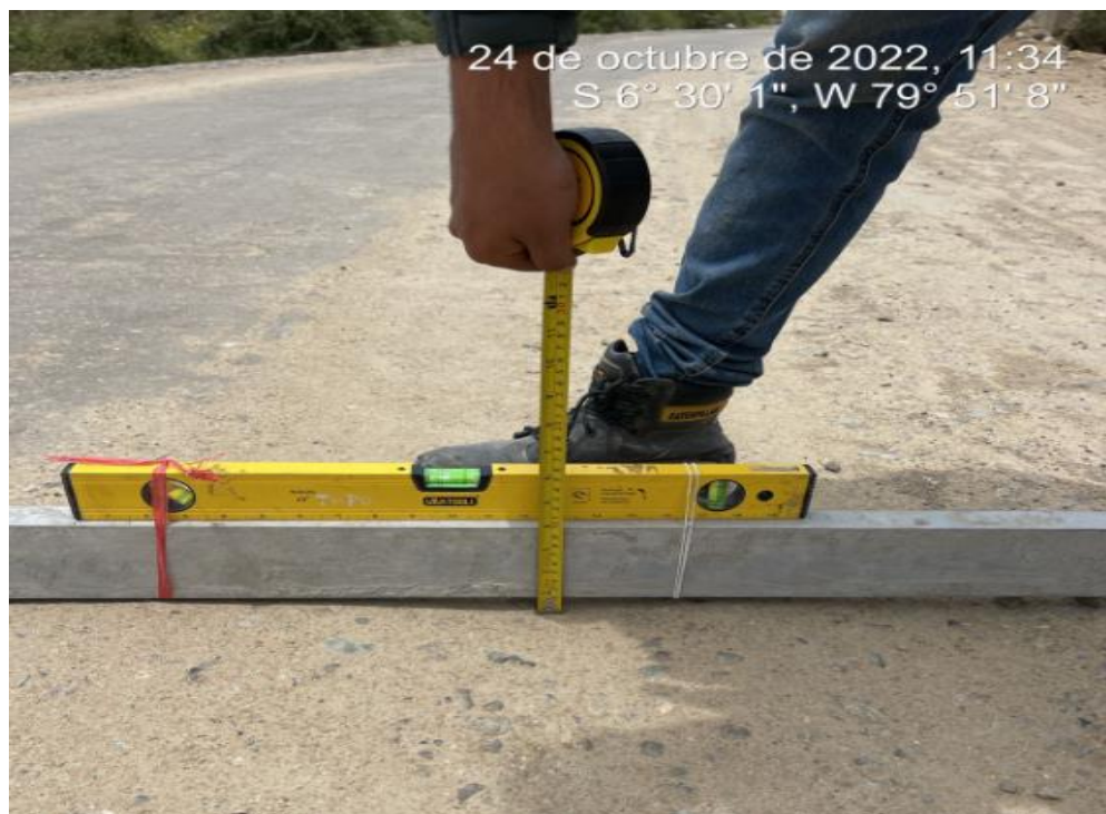
Ilustración 158: Ahuellamiento de aproximadamente 2 cm
