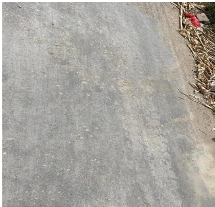
Ilustración 151: Presencia de pequeños ahuellamientos y desprendimientos
