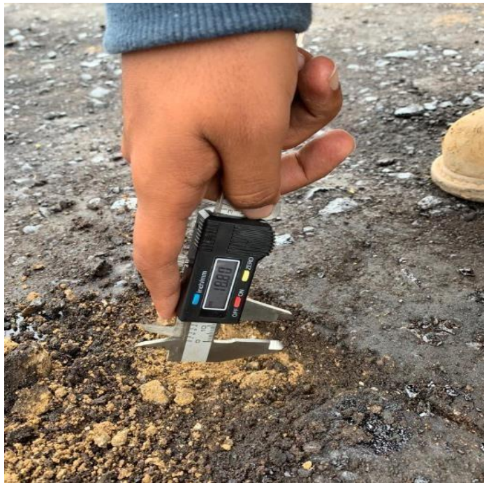
Anexo N°02.147: Penetración 18.80mm, progresiva 0+080km
