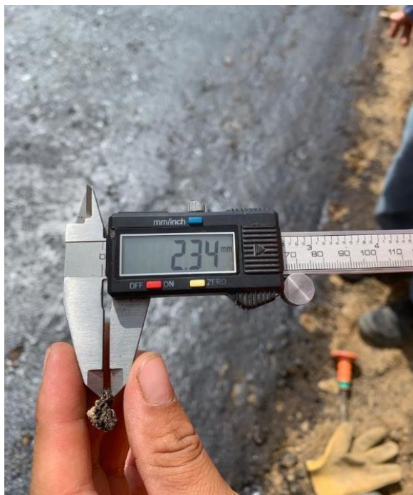
Anexo N°02.96: Penetración 2.34mm, progresiva 0+000km
