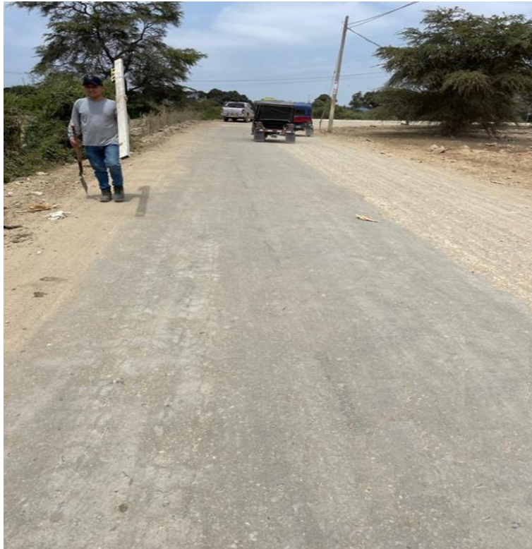
Ilustración 150: Peladuras por el tránsito de vehículos con orugas
