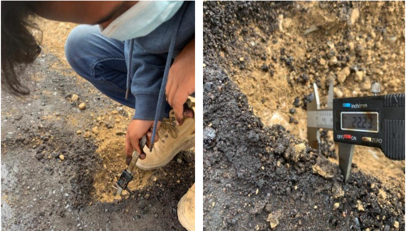
Anexo N°02.151 y 152: Penetración 22.23mm, progresiva 0+120km
