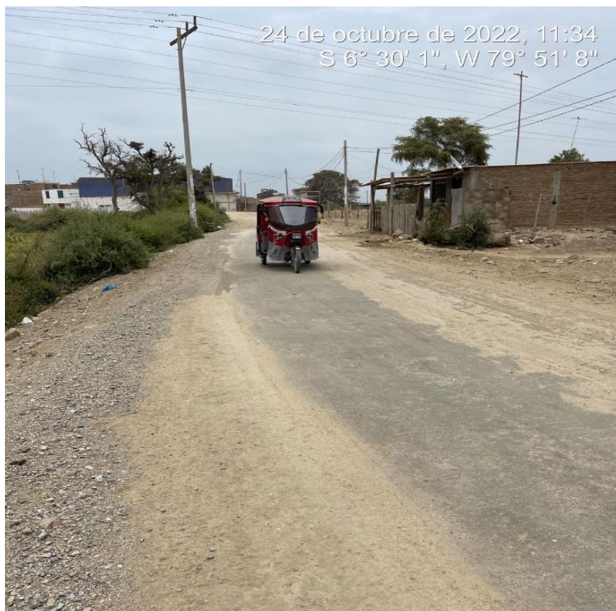
Ilustración 156: Presencia de peladuras y pérdida del revestimiento asfáltico
