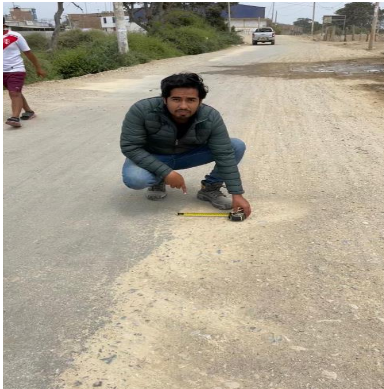
Anexo N°02.160: Desprendimiento o disgregamiento con severidad alta
