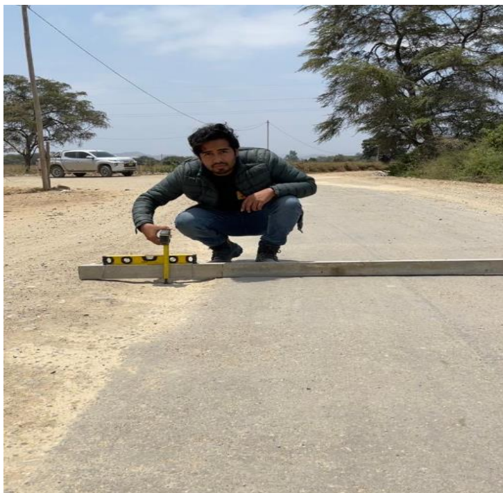
Anexo N°02.160: Ahuellamiento de baja severidad
