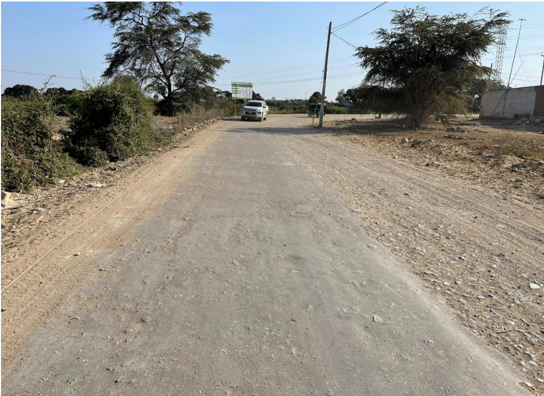
Ilustración 159: Presencia de pequeños baches con severidad baja
