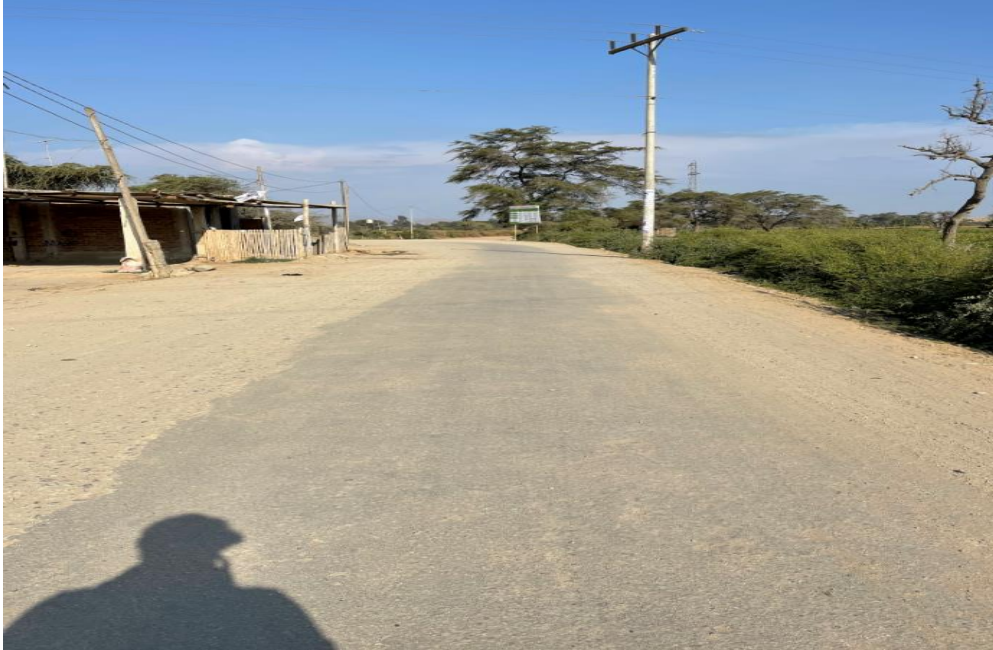
Ilustración 153: Pérdida del revestimiento asfáltico
