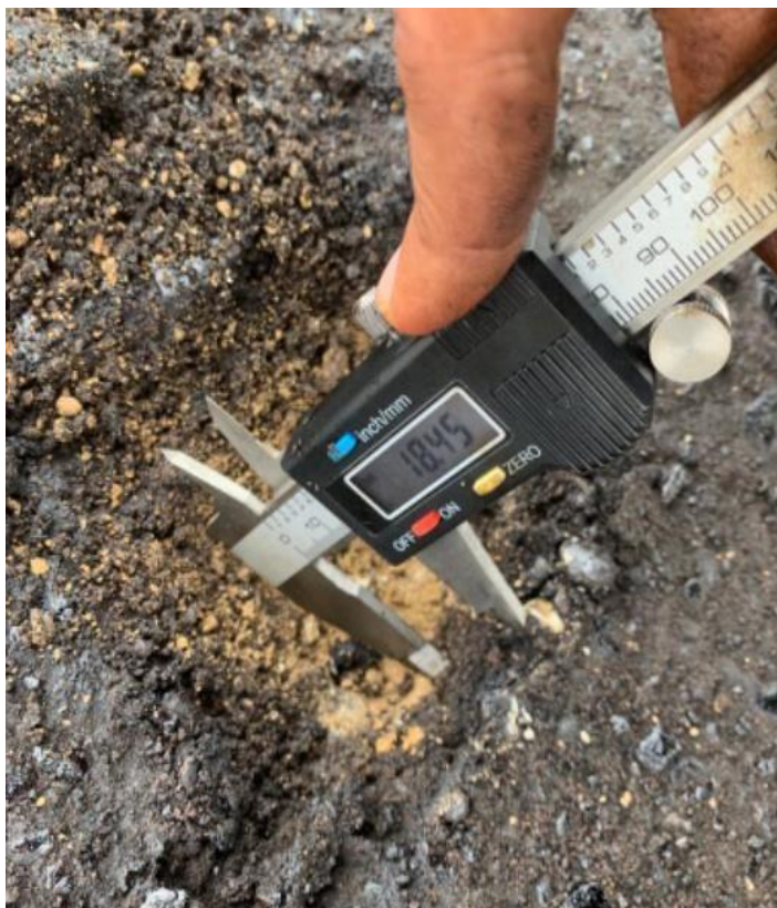
Anexo N°02.149: Penetración 18.45mm, progresiva 0+100km
