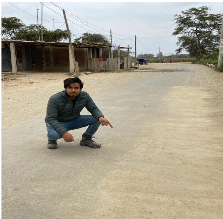
Anexo N°02.160: Pérdida de revestimiento asfáltico, generación de polución
