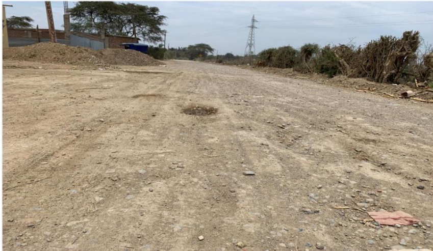
Anexo N°01.1: Fallas de la carpeta de rodadura del camino vecinal Payesa, entrada al Bosque de Pómac
