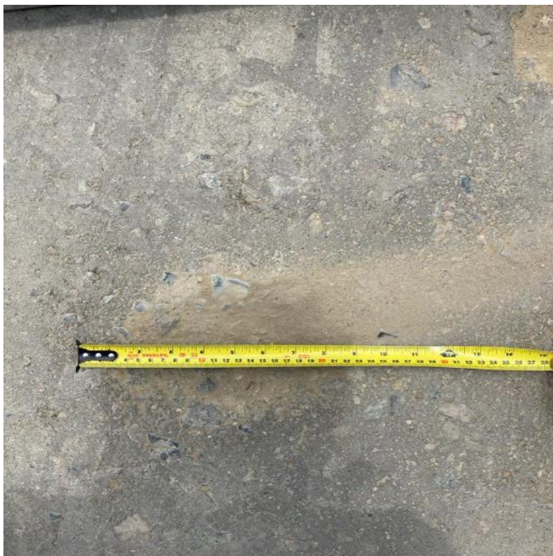
Anexo N°02.160: Presencia de pequeños baches con severidad baja
