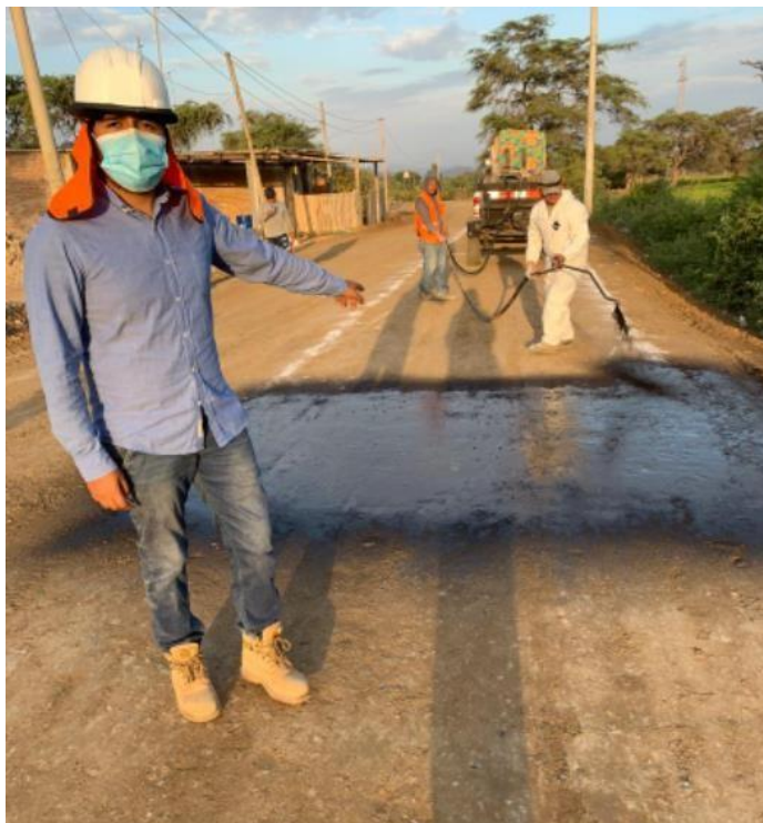
Anexo N°02.92: Imprimación de la emulsión asfáltica CSS-1h con una tasa de aplicación de 1.95 lt/m 2
