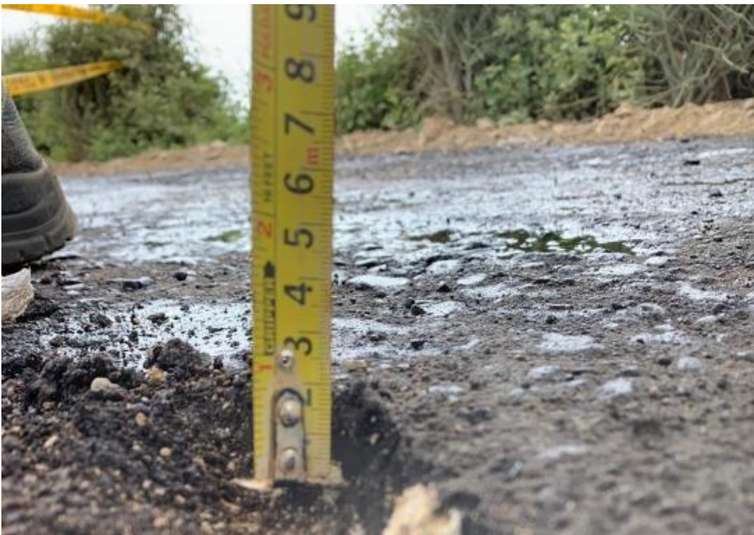
Anexo N°02.153: Penetración 20.00mm, progresiva 0+130km
