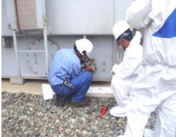
Figura 14. .Toma de muestra en transformador de potencia SEP Chiclayo Norte.
