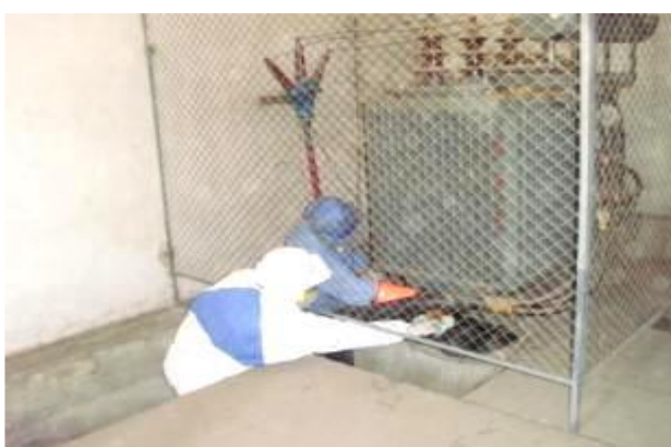
Figura 13. Toma de muestra en transformador de potencia de subestación 395, en Urb. Ciudad del Chofer.
