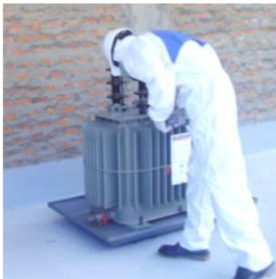
Figura 15. . Observación visual de transformador de potencia en área taller de mantenimiento.
