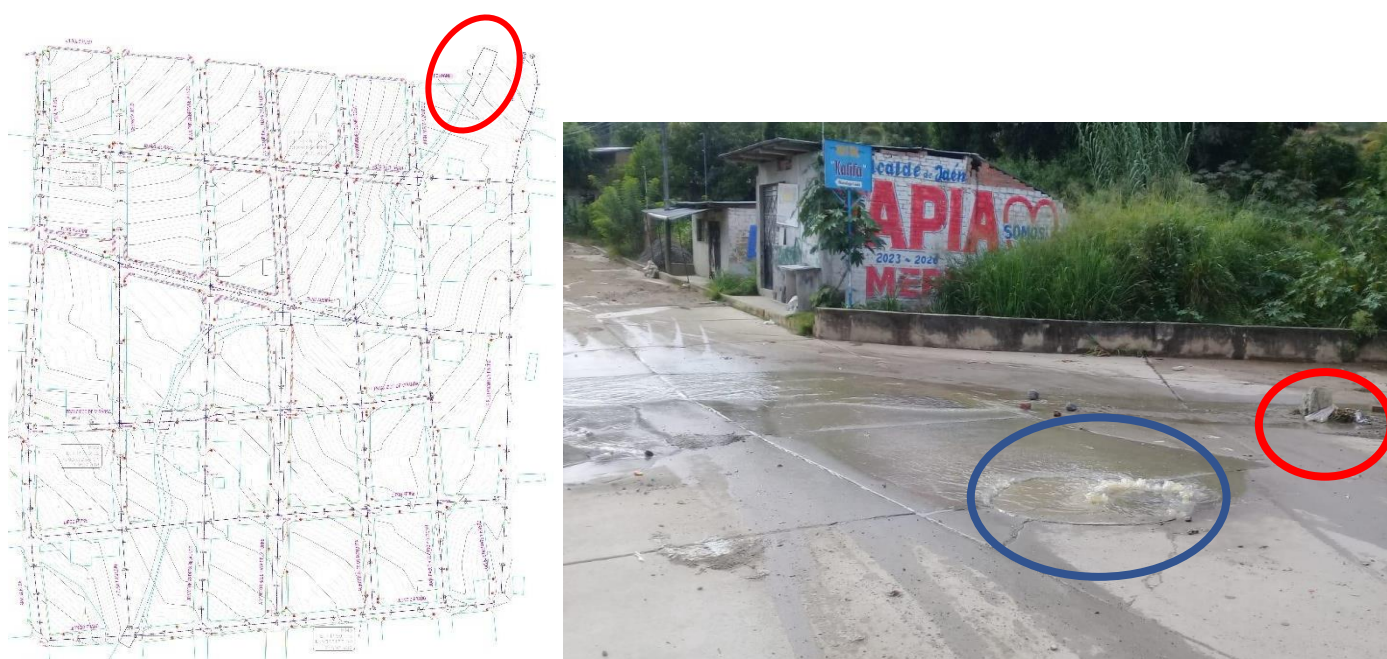
Ilustración 54 Colapso de buzón, intersección Francisco Bolognesi con Juan Pablo Vizcardo y Guzmán, Fila Alta. Fuente: Elaboración propia.
