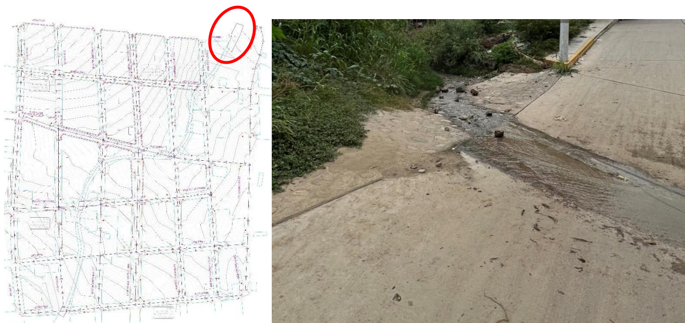
Ilustración 53 Cara anterior del recorrido final de la Zanja Honda, intersección Francisco Bolognesi con Juan Pablo Vizcardo y Guzmán, Fila Alta. Fuente: Elaboración propia.
