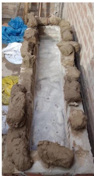
Anexo 113 Estado de las unidades del muro patrón después del volteo
