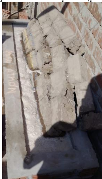
Anexo 112 Desmoronamiento repentino del muro patrón (a los 29 minutos)
