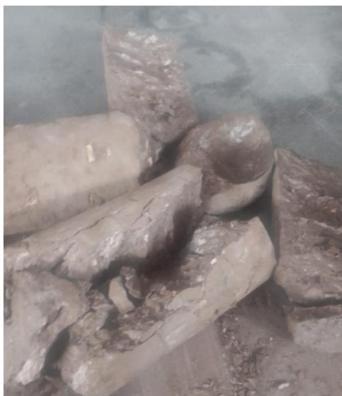
Ilustración 121 Estado de falla de las unidades cilíndricas 1Y
