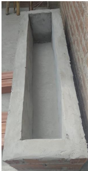
Ilustración 155 Poza de albañilería impermeabilizada para MP
