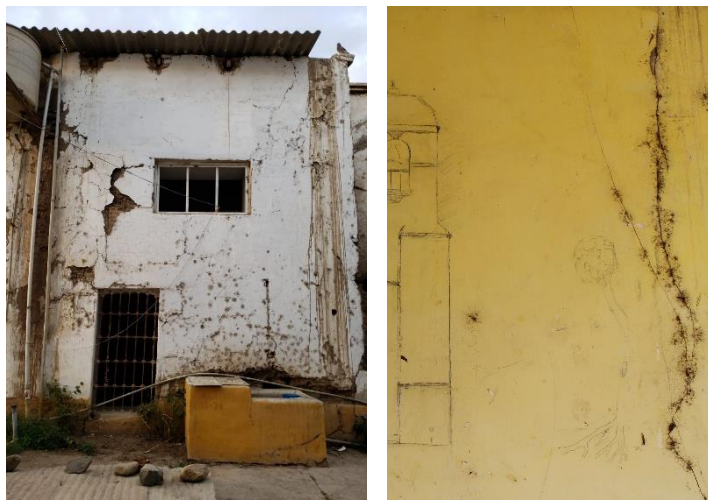
Figura 29. Lesión Grietas. Figura 30. Lesión Fisuras. Fuente: Elaboración propia.
