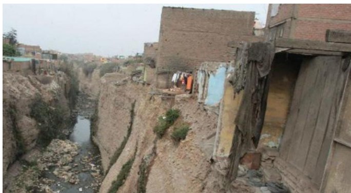
Ilustración 3: Edificaciones expuestas a un peligro de origen natural
