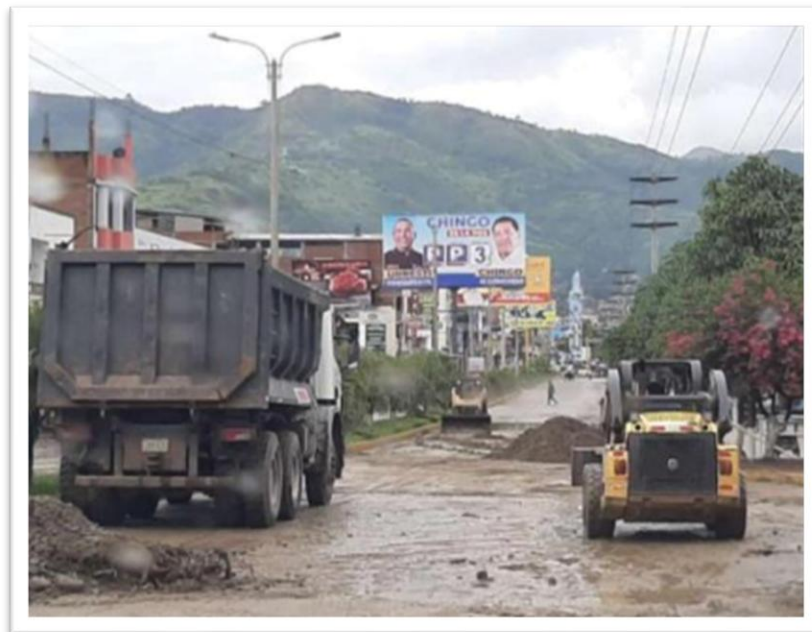
Ilustración 18: Limpieza de restos por inundación
