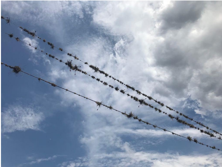
Figura 40: Línea 10KV para mantenimiento – Lado D
