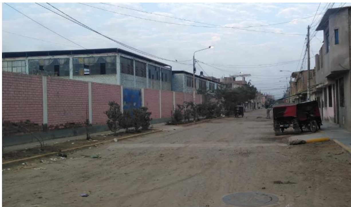
Anexo 4: El mal estado de la pavimentación en el I.E. 10797 MICAELA BASTIDAS; Fuente: Propia
