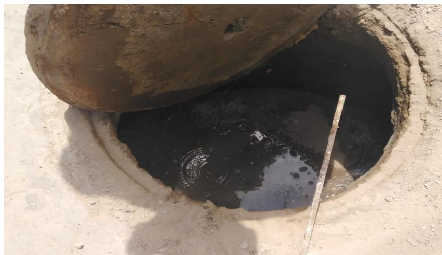
Fig. 8: Inspección de los Buzones (Colmatado); Fuente: Propia.
