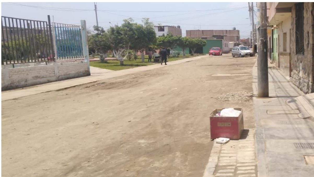
Anexo 7: Pavimentación en mal estado de la calle José Carlos Mariátegui; Fuente: Propia
