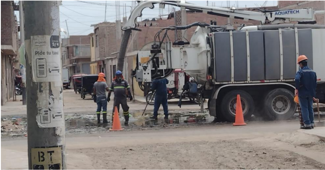
Anexo 1: Desatoro en la calle México y Mariátegui del 04/04/2022; Fuente: Propia
