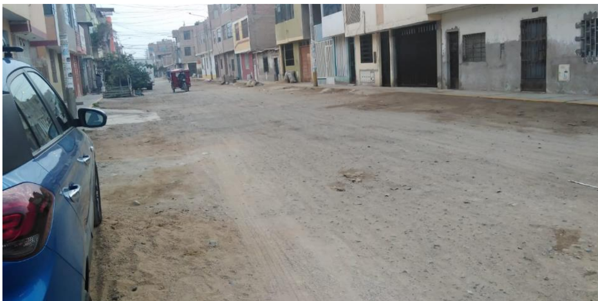
Anexo 6: Calle en mal estado de Virrey Toledo, se encuentra en la intersección de ambos pueblos jóvenes; Fuente: Propia
