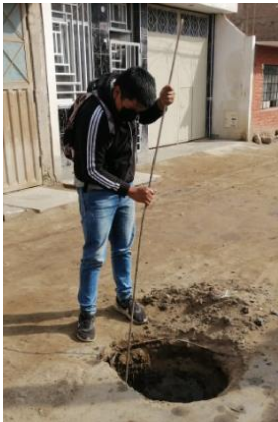
Anexo 5: Inspección de Buzones en Francisco Cabrera y Micaela Bastidas; Fuente: Propia
