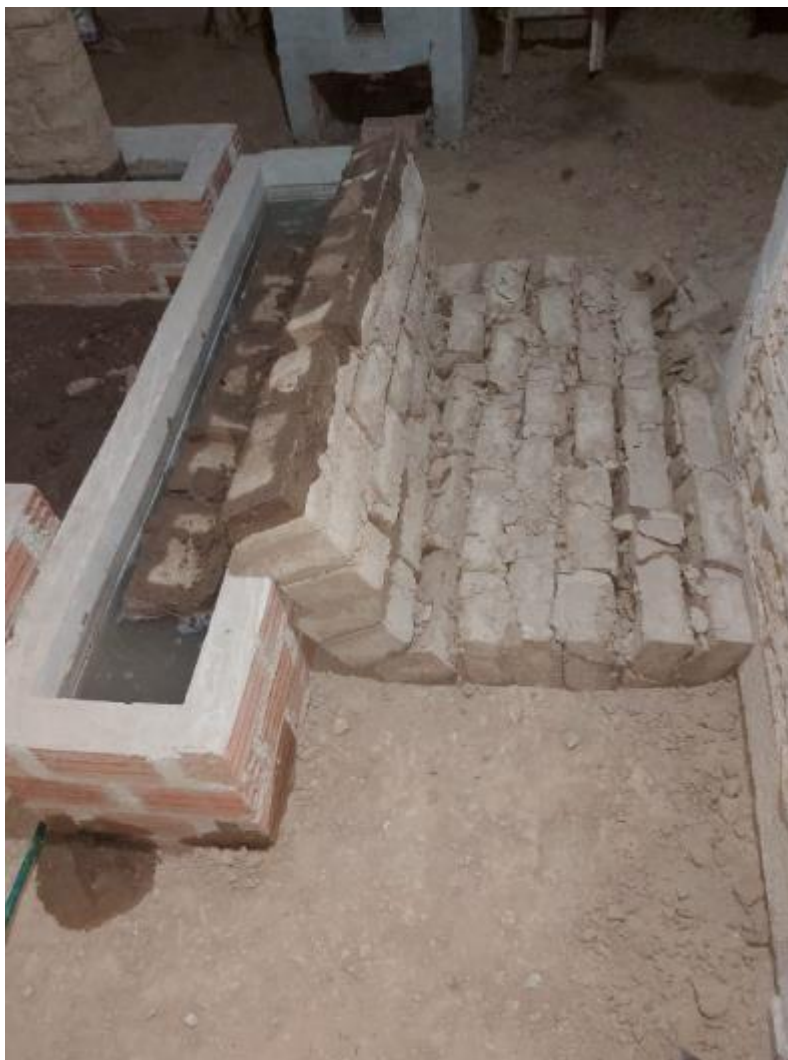
Figura 34. Volteo de muro de Adobe más 6% de mucílago de algarrobo
