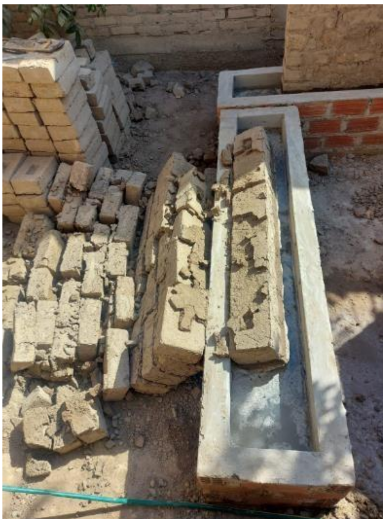
Figura 33. Volteo de muro de Adobe Patrón
