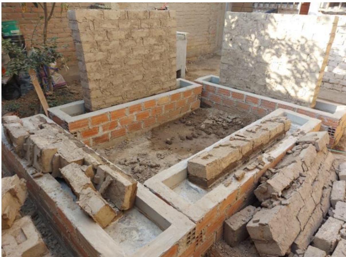
Figura 35. Volteo de muro de Adobe más 2% de mucílago de algarrobo
