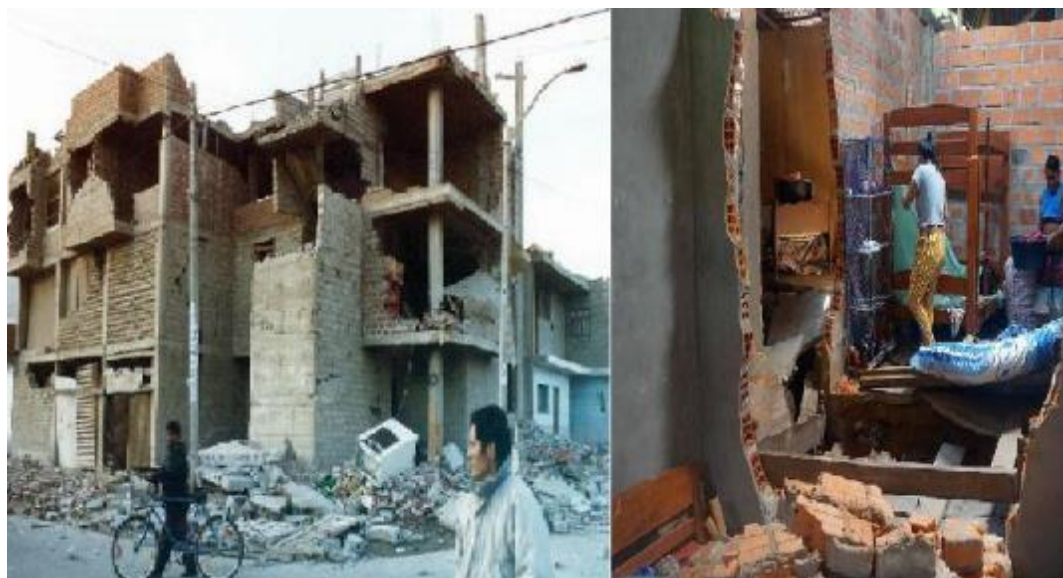
Imagen 1. Malos procesos constructivos en obra y mano no calificada en muros de la albañilería
