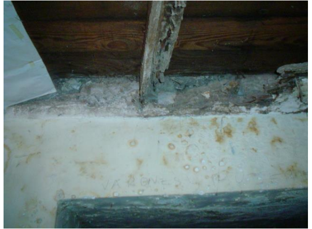
AMPOLLAMIENTO Y VIGA DE CONCRETO
