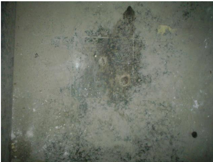
VISTA DE LOSETA4 CON APARIENCIA SUCIA Y CON RESIDUOS DE CONCRETO ADHERIDOS
