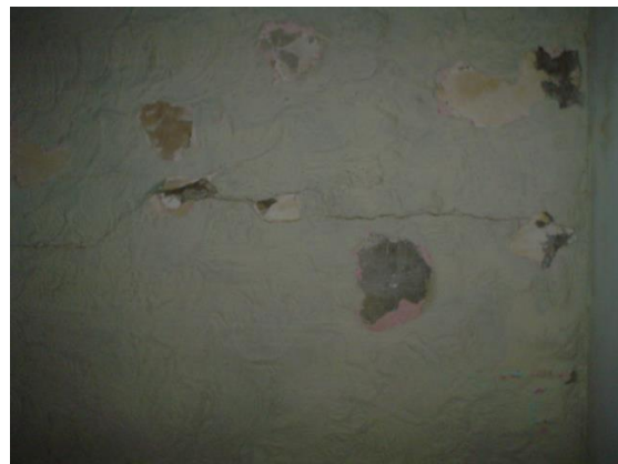
DETALLE DE FISURA Y DESPRENDIMIENTO DE ENLUCIDO Y REVOQUE.
