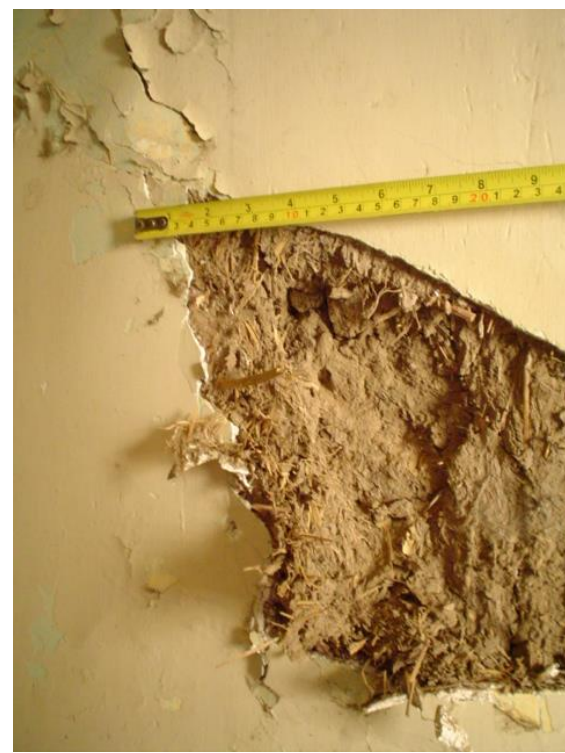
DETALLE DEL DESPRENDIMIENTO QUE HA SUFRIDO EL ENLUCIDO.
