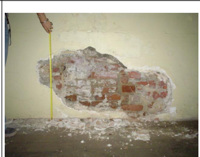
DETALLE DE LA HUMEDAD DEL MURO Y DESPRENDIMIENTO DE ENLUCIDO
