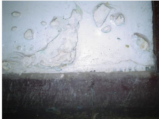
DETALLE DE INFLAMIENTO EN MURO DE LADRILLO
