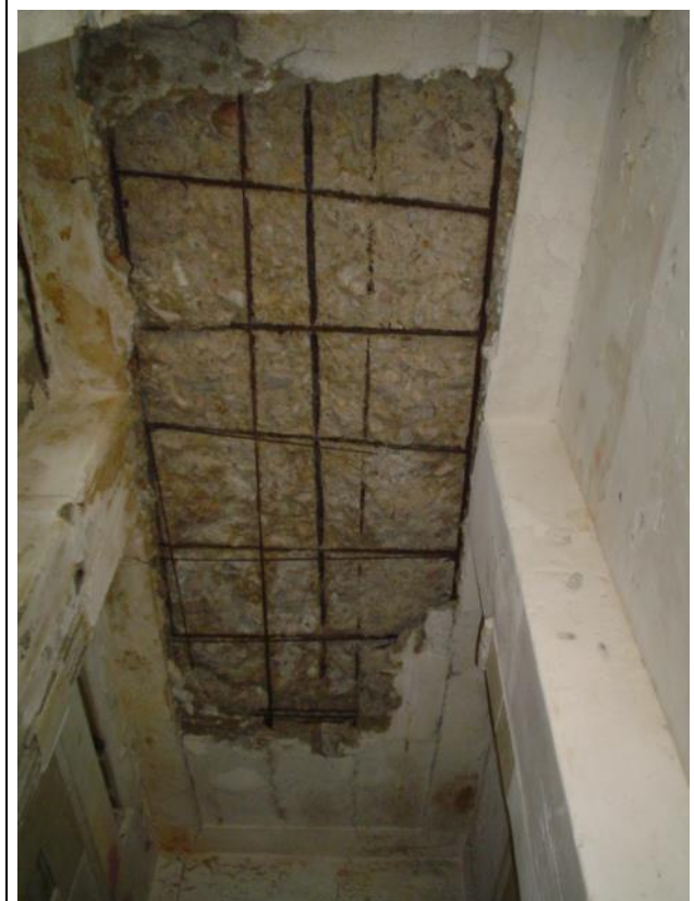
ESTADO DE TECHO CON EMPARRILLADO DE FIERRO
