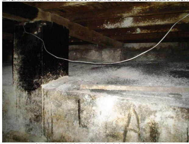
INSTALACIONES ELECTRICAS SIN EMPOTRAR
