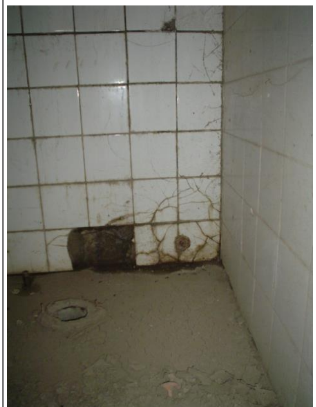
AGRIETAMIENTO EN MAYOLICA Y PRESENCIA DE HUMEDAD, SE APRECIA TAMBIEN LA INSTALACION DE DESAGUE PARA INODORO
