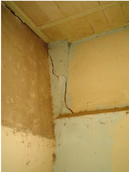
COLUMNA EN ESQUINA DETALLE DE LESION.
