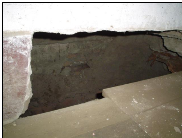
DETALLE DE LA PERDIDA DE ADOBE POR DERRUMBE.
