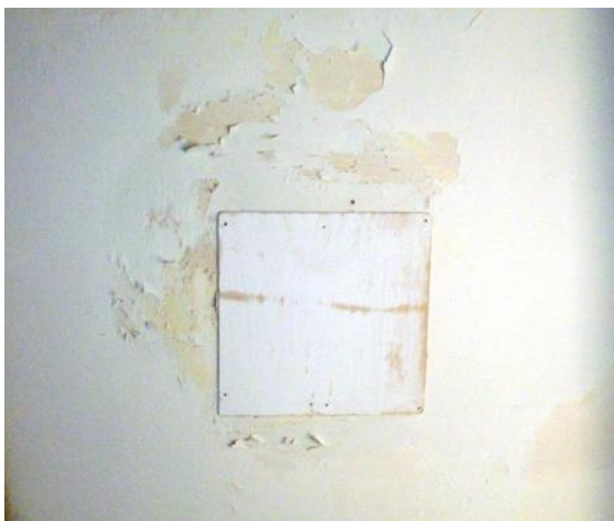
ENTREPISO HUMEDAD Y DESPRENDIMIENTO DE PINTURA
