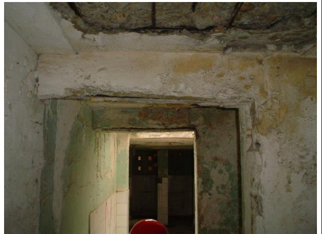
ESTADO DE MUROS Y TECHO
