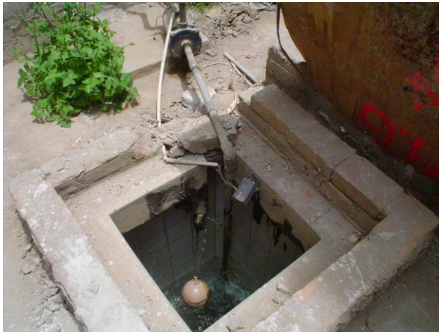
DETALLE DE CISTERNA Y BOMBA DE AGUA
