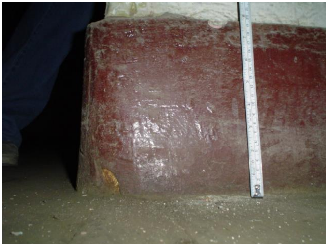
DETALLE DEL CONTRAZOCALO DE CEMENTO ESMALTADO COLOR CAOBA QUE SE ENCUENTRA EN TODO ELÑ PASILLO DERECHO.
