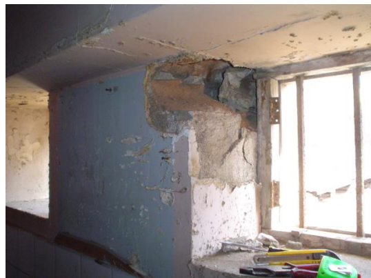
MURO DE LADRILLO PRESENTA DESPRENDIMIENTO DEL ENLUCIDO Y REVOQUE , PERDIDA DEL MATERIAL Y FISURAS VERTICALES.
