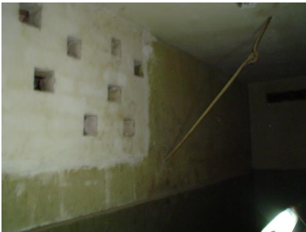
DETALLE DE VENTANA TAPIADA.
