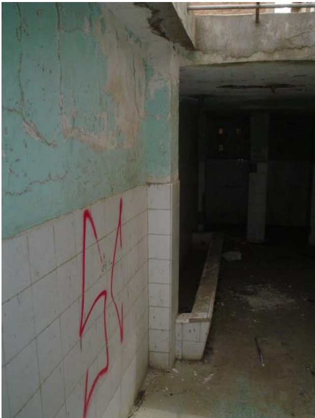
PAREDES CON AMPOLLAMIENTO Y MANCHAS
