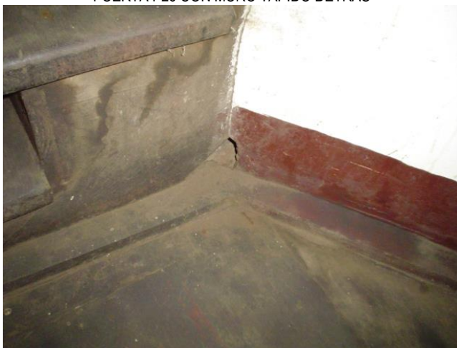
HUMEDAD EN ESCALERA2 (IZQUIERDA)
