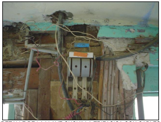
DETALLE DE LA LLAVE CUCHILLA TRIFASICA CON CABLES EXPUESTOS.
