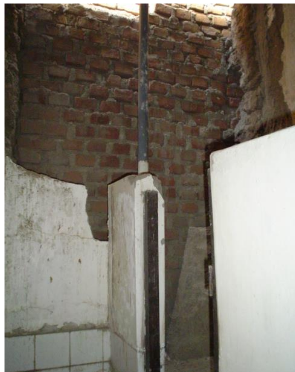
DETALLE DEL DERRUMBE DEL MURO DE ADOBE Y SU RESTAURACION CON LADRILLO
