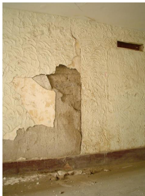
DISGREGACION QUE AFECTA LOS ESTRATOS TANTO DE LA CAPA PICTÓRICA COMO DEL ENLUCIDO Y REVOQUE.
