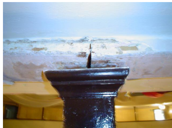
DETALLE DEL DESPRENDIMIENTO DE LA COL20 CON LA VIGA SEMI CIRCULAR DE LA PLATEA DEL 2do NIVEL
