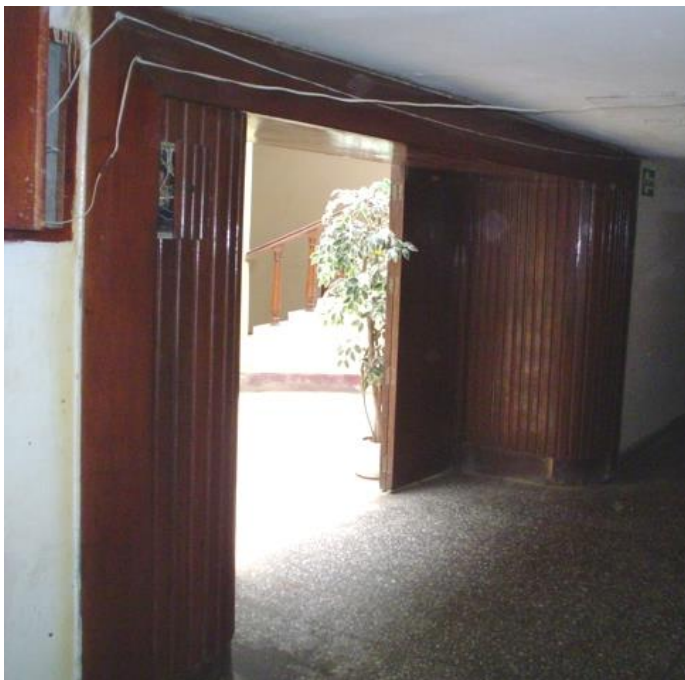
VISTA DE PUERTA P08 Y EL CABLEADO SIN EMPOTRAR
