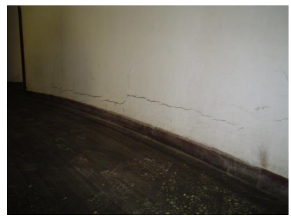
VISTA DE FISURAS HORIZONTALES EN MURO DE LADRILLO
