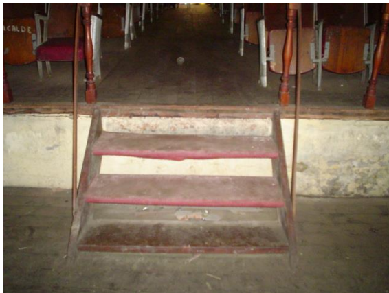
ESCALERA DE MADERA DE 3 PASOS, SOBREPUESTA Y ARRIOSTRADA A LA BARANDA.
