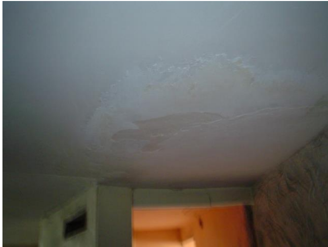
DETALLE DE HUIMEDAD Y DECOLORACION DE LA CAPA PICTÓRICA DEL ENTREPISO DEL PASILLO DEL TERER NIVEL.
