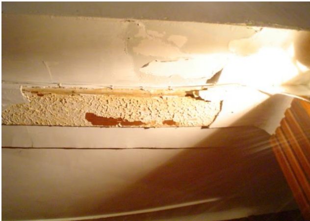
DESPRENDIMIENTO DE REVOQUE DE YESO EN VIGA SEMI CIRCULAR QUE FORMA LA HERRADURA Y SOPORTA LA GALERIA DEL SEGUNDO NIVEL
