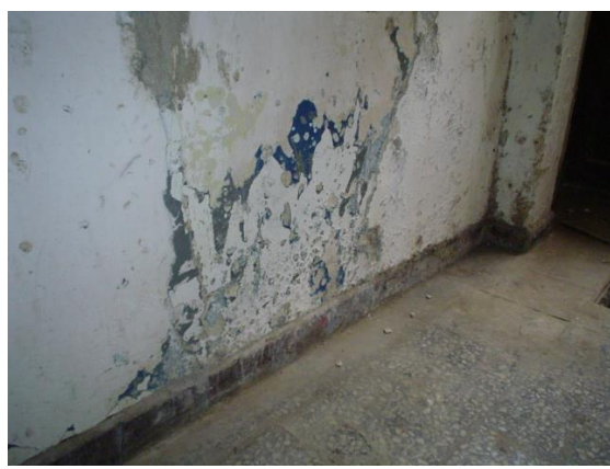
DETALLE DE EXFOLIACION Y LAGUNAS EN MURO DE ADOBE
