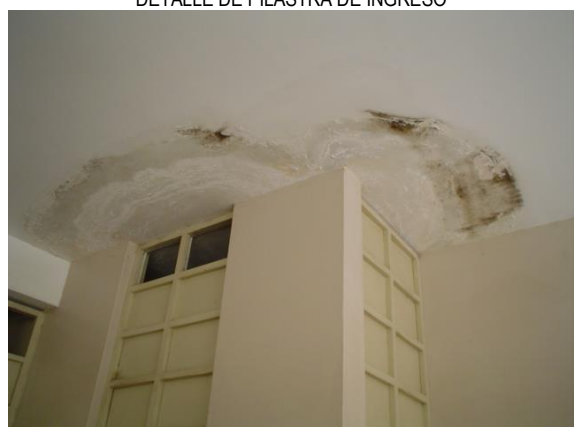
DETALLE DE HUMEDAD DE ENTREPISO EN CONSTRUCCIÓN MODERNA
