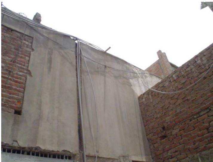
CABLEADO ENTUBADO SIN EMPOTRAR
