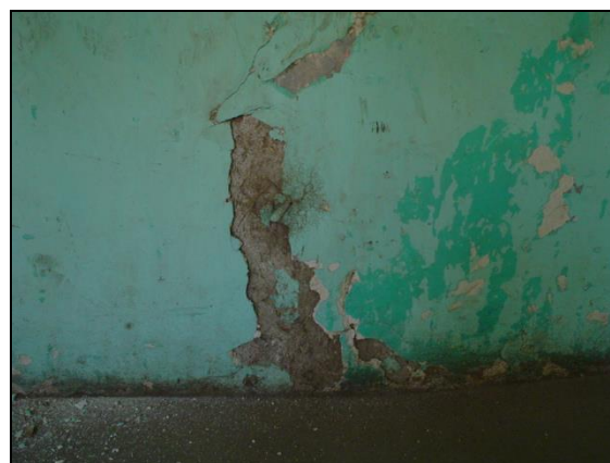
DETALLE DEL DESPRENDIMIENTO QUE HA SUFRIDO LA PINTURA ADEMÁS DE TENER MANCHAS Y HUMEDAD.
