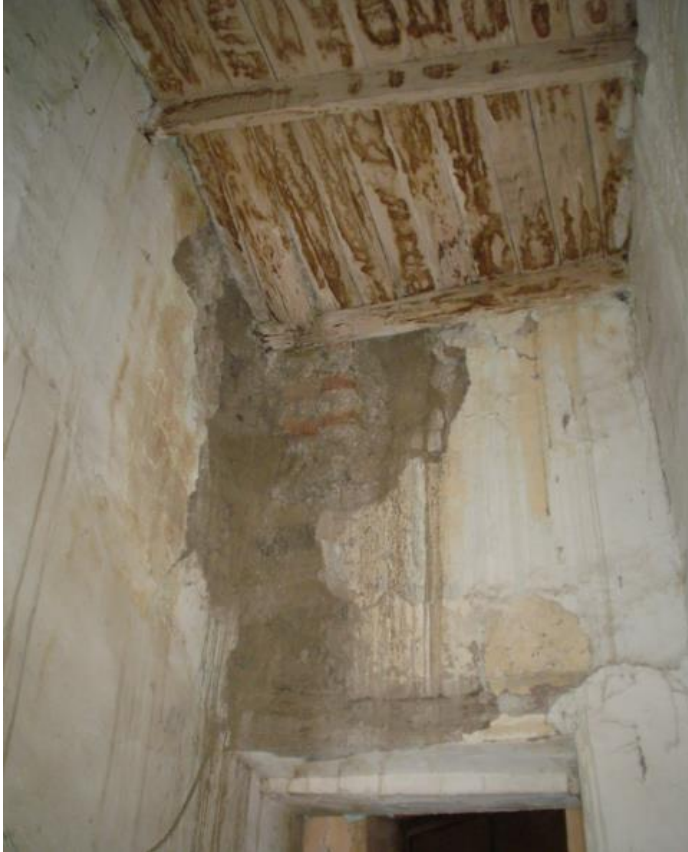
VISTA DE CIELO RAZO HUMEDECIDO Y DESPRENDIMIENTO DEL REVOQUE EN LA PARED SUPERIOR AL DINTEL DE INGRESO AL PASILLO
