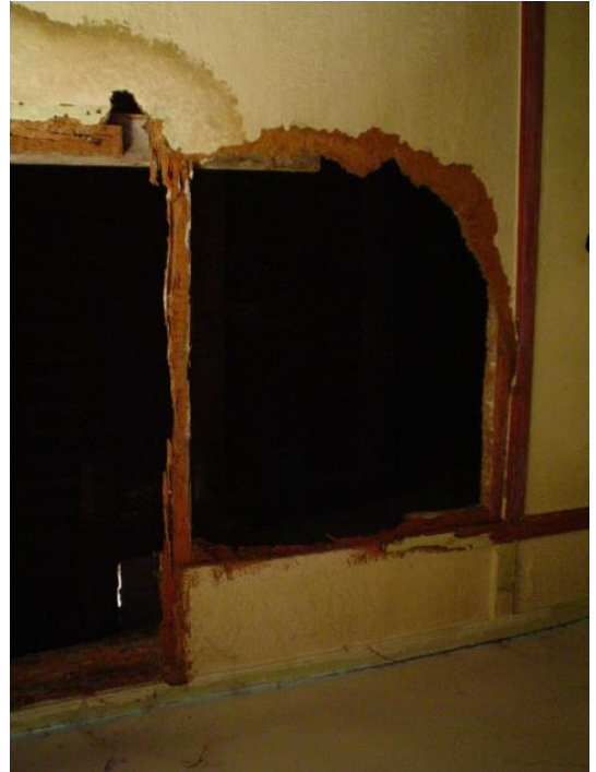
DETALLE DE ESTRUCTURA DE MADERA DEL CIELO RASO, SE ENCUENTRA TOTALMENTE APOLILLADA.
