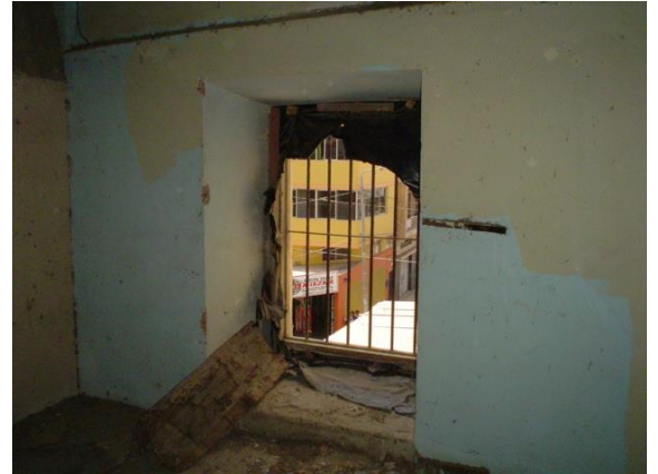
DETALLE DE LA VENTANA 39, ES BAJA Y TIENE UN ENREJADO DE FIERRO.
