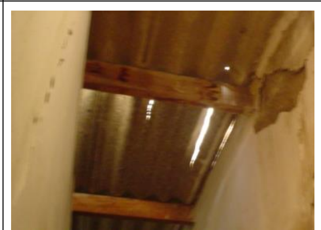
DETALLE DEL ESTADO DE LAS VIGAS DE MADERA Y REVOQUE DEL MURO.
