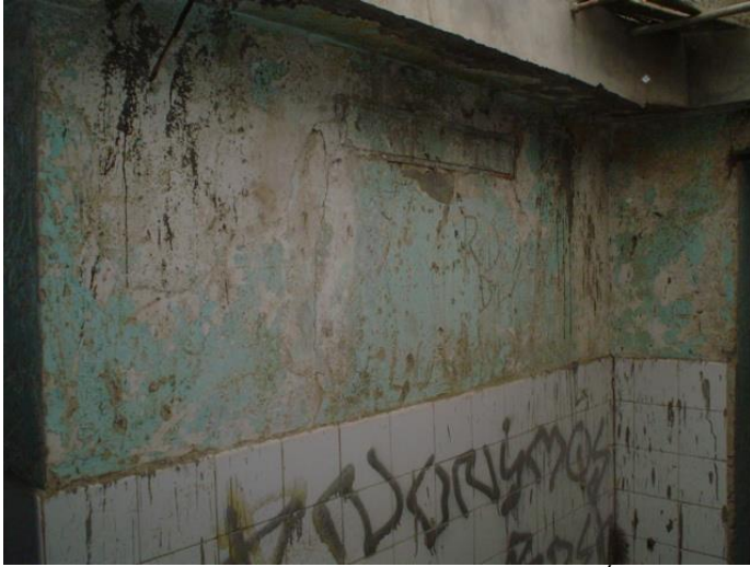
ESTADO DE REVOQUE EN PAREDES Y MANCHAS EN ZÓCALO CON ENCHAPE DE MAYOLICA
