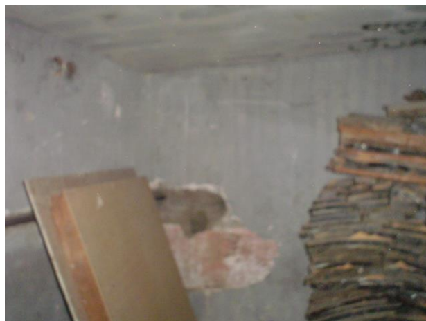
DETALLE DE DESPRENDIMIENTO EN LA PARTE POSTERIOR DEL AMBIENTE
