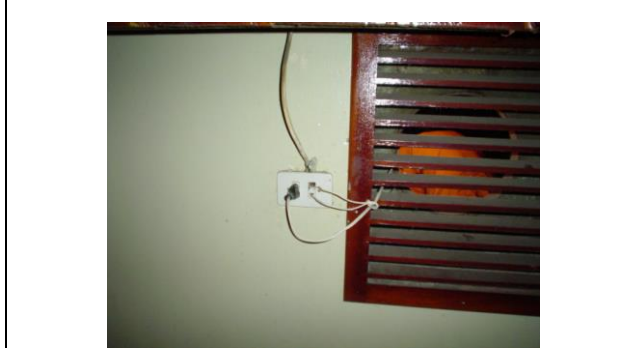
INTERRUPTOR DONDE SE CONECTA A MOTOBOMBA.
