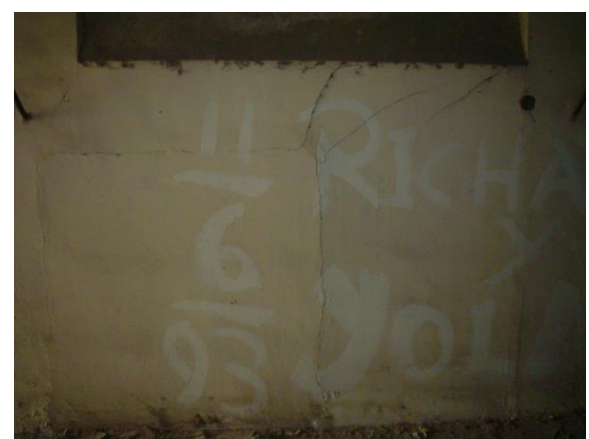
DETALLE DE LESION QUE PRESENTA EL MURO (MANCHA) Y FISURAS VERTICALES
