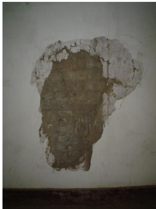
DESPRENDIMIENTO DE REVOQUE Y PRESENCIA DE HUMEDAD.
