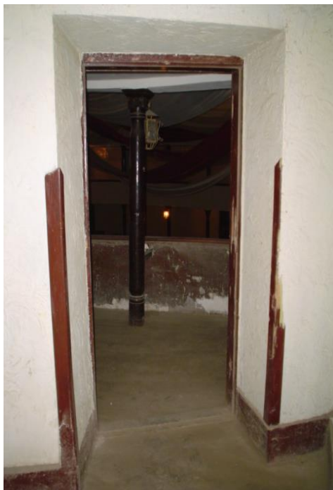
DETALLE DE PUERTA 35, SOLO TIENE MARCO DE MADERA.
