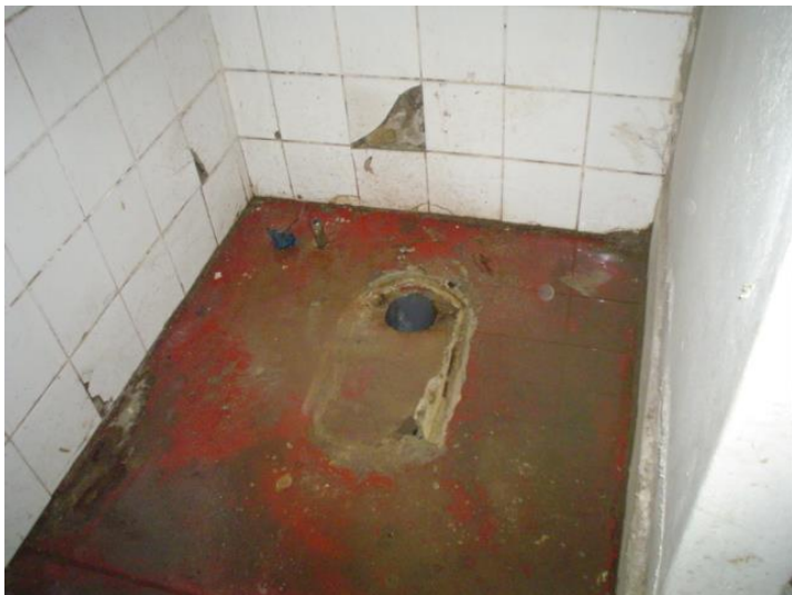
INSTALACION SANITARIA Y ANEGAMIENTO DE AGUA
