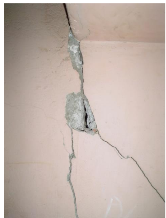
DETALLE DE LA FISURA ENTRE LA UNION DEL MURO Y LA VIGA QUE PASA POR ESTE AMBIENTE.
