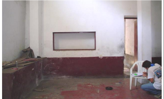
VISTA DEL MURO PRESNETA TIZAMIENTO, A LA DERECHA SE APRECIA LA PUERTA P12
