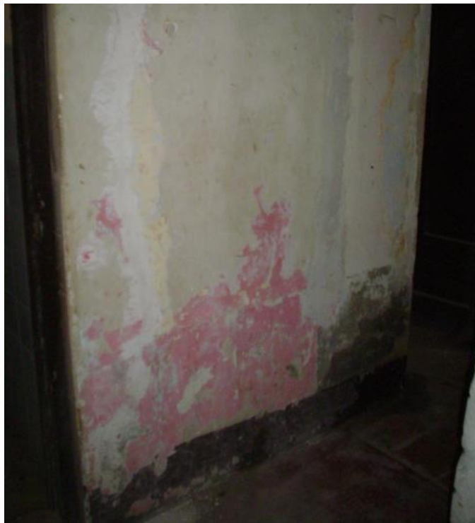
DESPRENDIMIENTO DE PINTURA Y RESANE EN MURO
