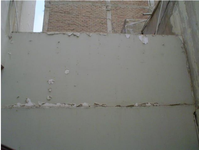
ESTADO DE LA PINTURA DE LA ZONA ANTIGUA
