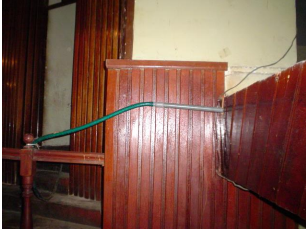
TUBO DE PVC EXPUESTO DE 4" DONDE SE CONECTA UNA MANGUERA QUE EVACUA EL AGUA DE LA MOTOBOMBA.
