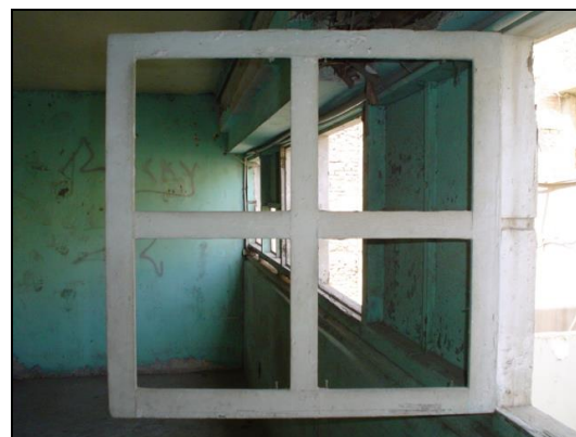
DETALLE DE LA VENTANA 16 DE MADERA CON VIDRIO BAJA TIPO BATIENTE DE DOBLE HOJA Y CON MARCO DE MADERA.
