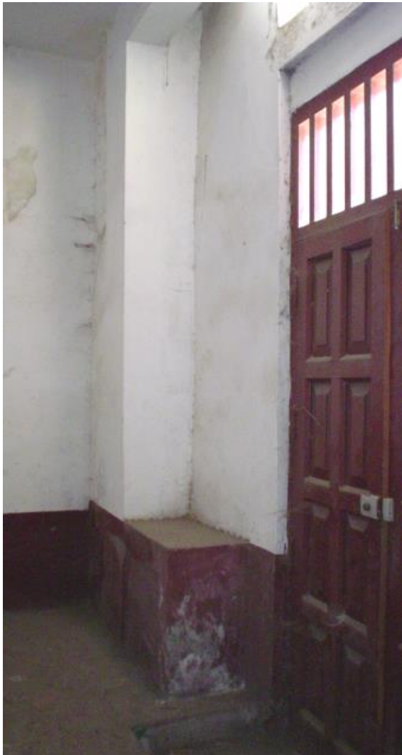
DETALLE EN EL QUE SE APRECIA LAS COMUNAS DE CONCRETO Y EL MURO DE ADOBE CON DEFORMACION VERTICAL Y UN PARAPETO
