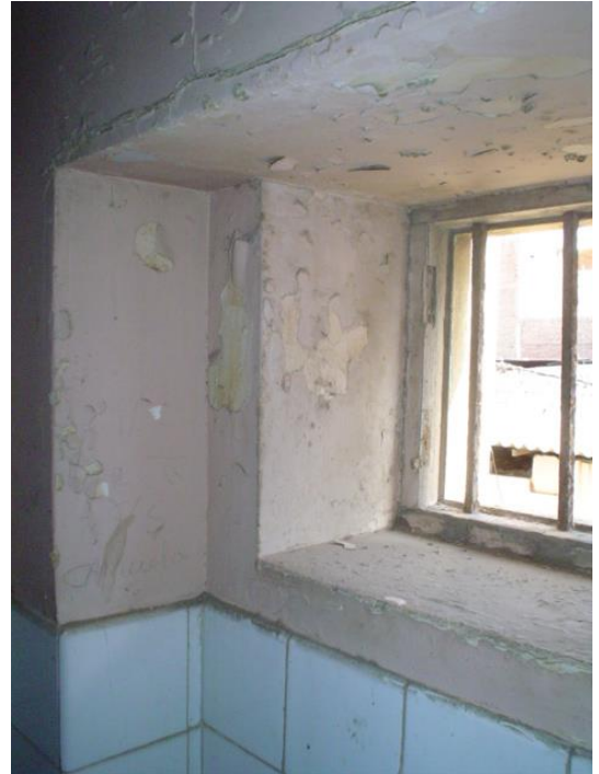
DETALLE DE LAS LESIONES QUE PRESENTA LA PINTURA: DESCASCARAMIENTO E INFLAMIENTO.
