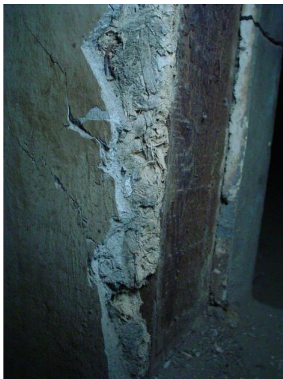
DETALLE DEL DESPRENDIMIENTO DEL ENLUCIDO Y DE LAS FISURAS QUE PRESENTA.
