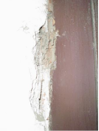
DISGREGACION DE ENLUCIDO JUNTO A PUERTA
