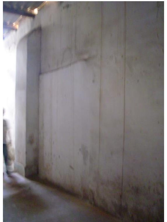
DETALLE HUMEDAD A LO LARGO DE LA BASE DEL MURO DE ADOBE Y TAPIADO DE PUERTA HACIA LA Ca. JUAN CUGLIEVAN, SE NOTA POR LA DEFORMACION DEL MURO
