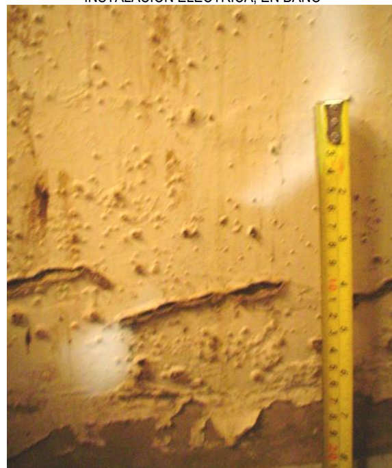
DETALLE DE AMPOYAMIENTO Y LAGUNAS EN PINTURA
