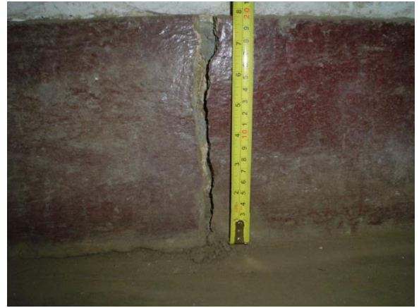
DETALLE DE FISURA VERTICAL EN CONTRAZOCALO DE CEMENTO.
