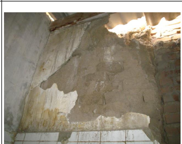
PERDIDA DE REVOQUE E INFLAMIENTO, APARIENCIA SUCIA Y TIZAMIENTO EN PARED IZQUIERDA
