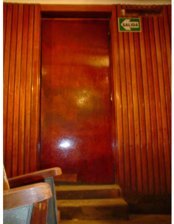
MACHIEMBRADO SOBRE MURO DE ADOBE, CAJA EMPOTRADA DE MADERA PARA FLUORESCENTE EN LADO DERECHO DE LA PUERTA
