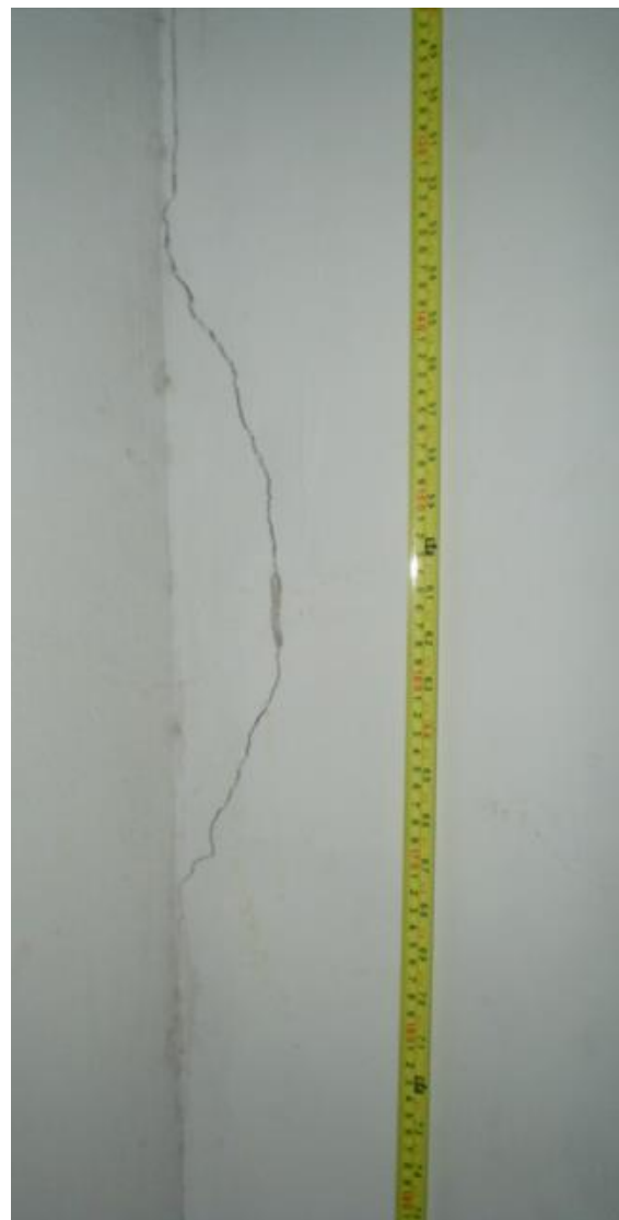
FISURA VERTICAL EN ENLUCIDO
