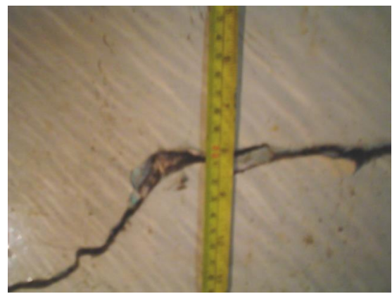
DETALLE DE FISURA HORIZONTAL EN MURO DE LADRILLO e = 8mm.
