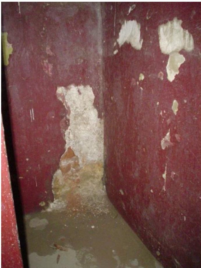
DETALLE DE DISGREGACION EN BASE DE MURO
