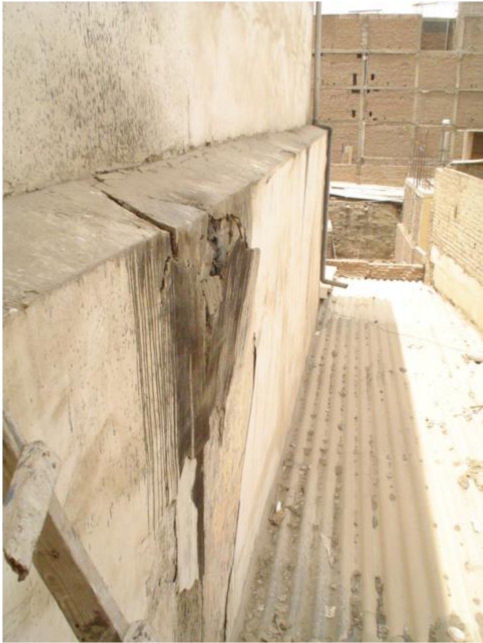
Estado exterior de Muro de Adobe de Escenario
