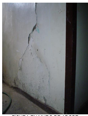
FISURA EN MURO DE ADOBE
