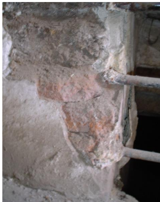
EROSIÓN Y DESPRENDIMIENTO EN BASE DEL MURO DE ADOBE, SE APRECIAN LOS BARROTES DE VENTANA DEL SOTA ESDENARIO
