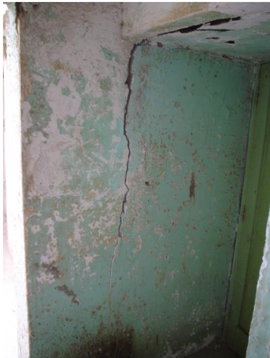
FISURA VERTUCAK EN MURO, AMPOLLAMIENTO Y PERDIDA DE CAPA PICTORICA
