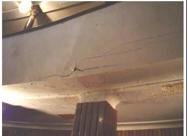
FALLA POR HUNDIMIENTO DE COLUMNA
