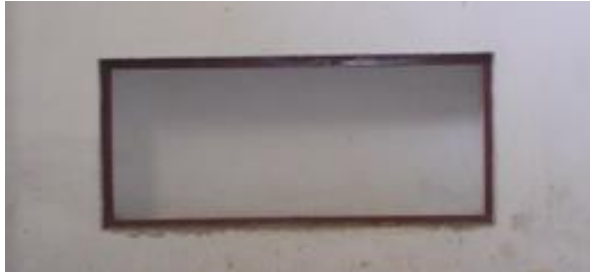
DETALLE DE FENETRACION EN MURO DE ADOBE, CON MARCO DE MADERA BARNIZADO EN BUEN ESTADO.
