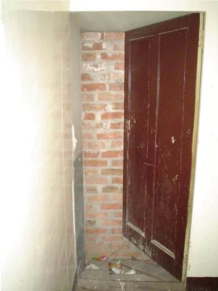
PUERTA P26 CON MURO TAPIDO DETRÁS
