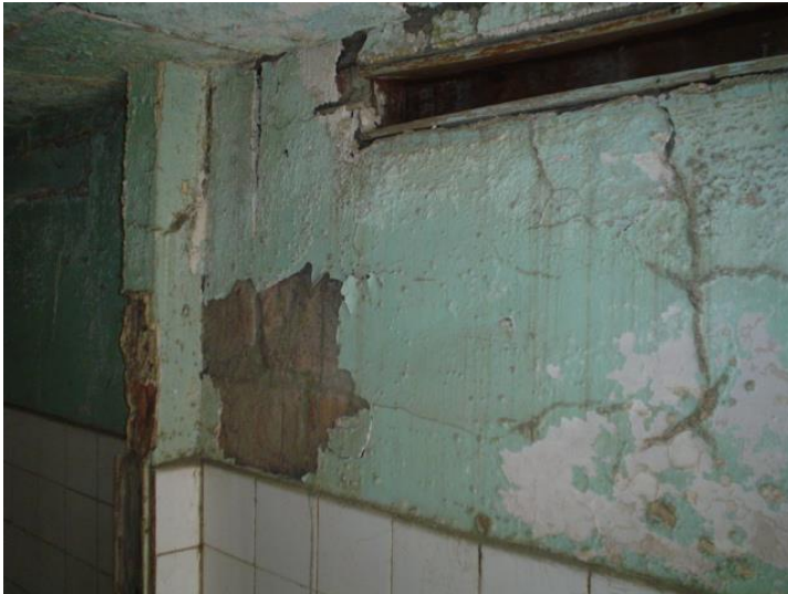
ESTADO DE REVOQUE EN PAREDES
