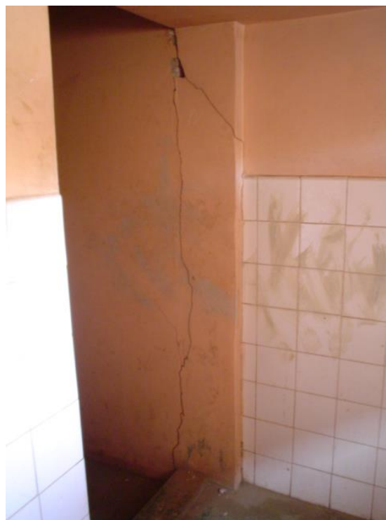
PRESENCIA DE FISURAS VERTICALES ENTRE EL PASILLO Y EL INGRESO DEL BAÑO DE MUJERES.
