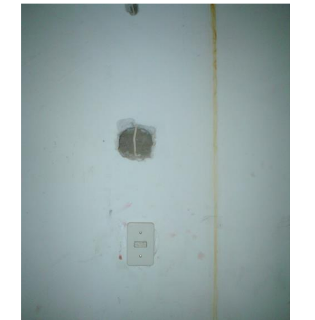
ESTADO DE INSTALACIONES ELECTRICAS
