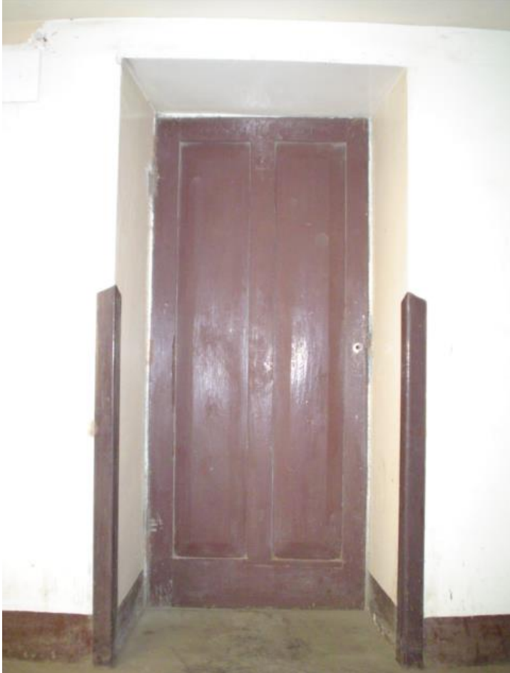
PUERTA P22 BATIENTES DE MADERA Y CON FILETES DE MADERA SOBRE MURO DE ADOBE
