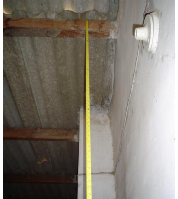
INSTALACION ELECTRICA Y HUMEDAD EN VIGAS
