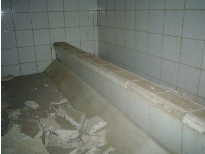
URINARIO DE OBRA
