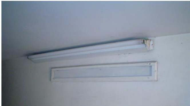
DETALLE DE INSTALACION ELECTRICA EMPOTRADA Y PUESTA SOBRE EL MURO DE ADOBE
