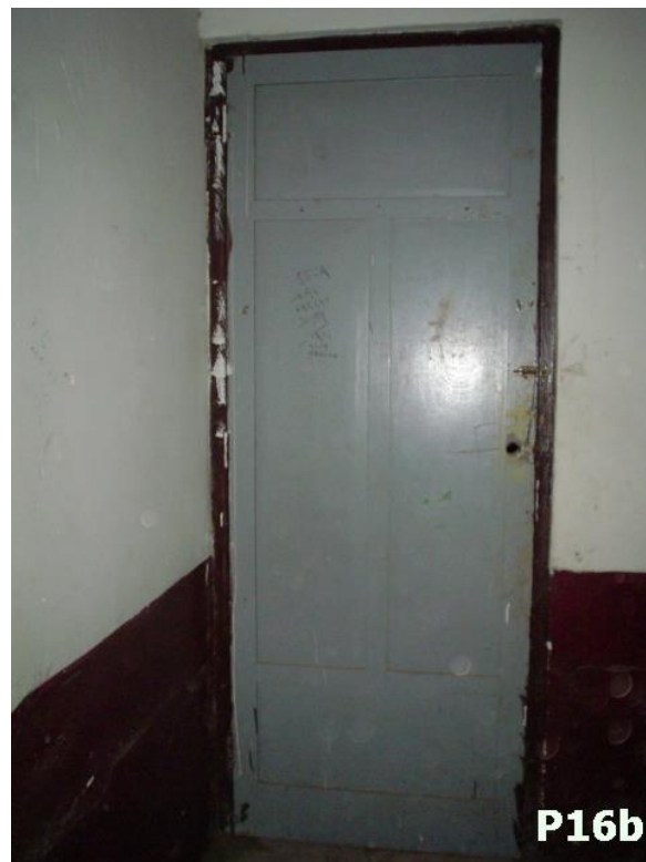
ESTADO DE PUERTA P16B, PINTURA ESMALTE PLOMO AL INTERIO Y CAOBA AL EXTERIOR
