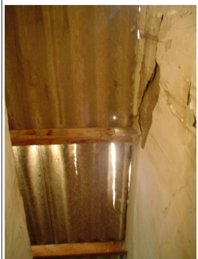
DETALLE DE FISURAMIENTO DE COBERTURA
