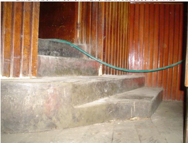
DETALLE DE ESCALERA POR DONDE PASA MANGUERA QUE EVACUA AGUA DE SOTA ESCENARIO
