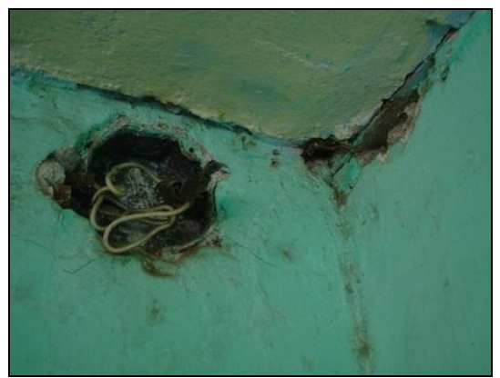
DETALLE DE LAS CAJAS EXAGONALES DE PARED CON CABLES VISTOS
