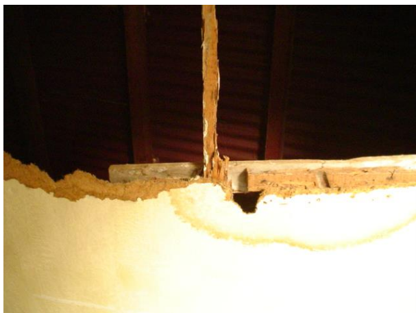
DETALLE DE LAS LESIONES QUE SUFRE LA ESTRUCTURA DEL CIELO RASO (APOLILLADO).
