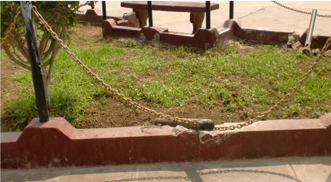
Figura 2. Mal estado del parque principal de la ciudad. Rosa Cubas Díaz, 2015.
