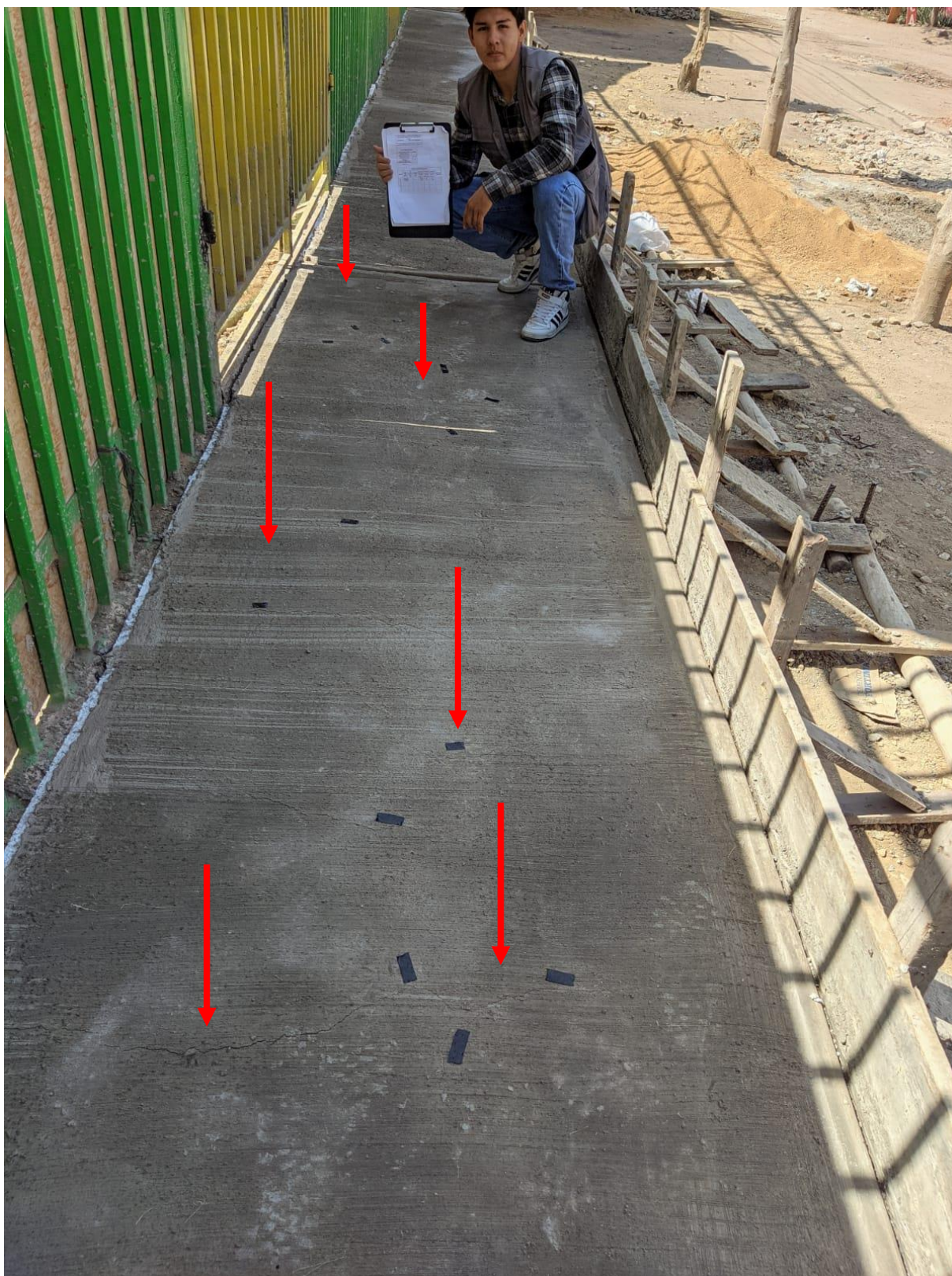
Ilustración 32. Fisuras en Losa + 20 kg/m 3 fibra comercial
