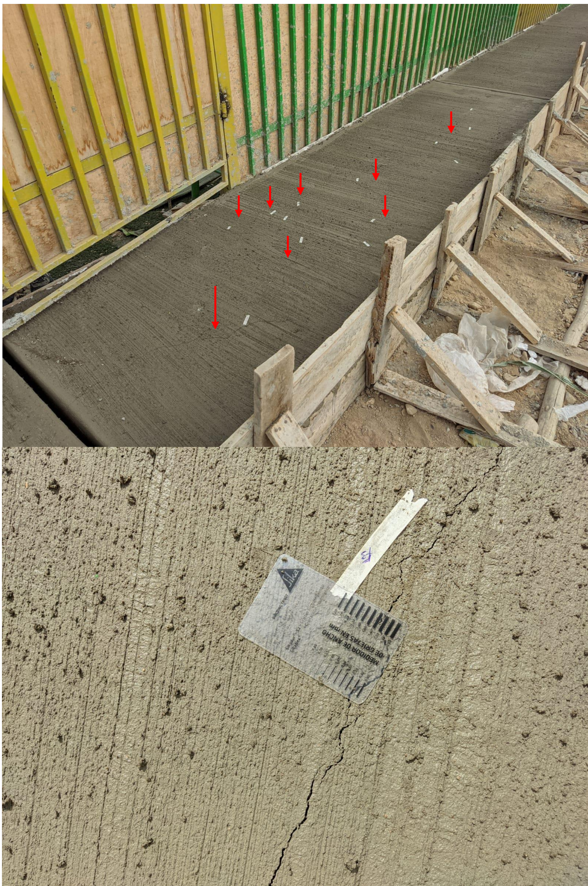
Ilustración 36. Fisuras en Losa + 10 kg/m 3 fibra de alambre
