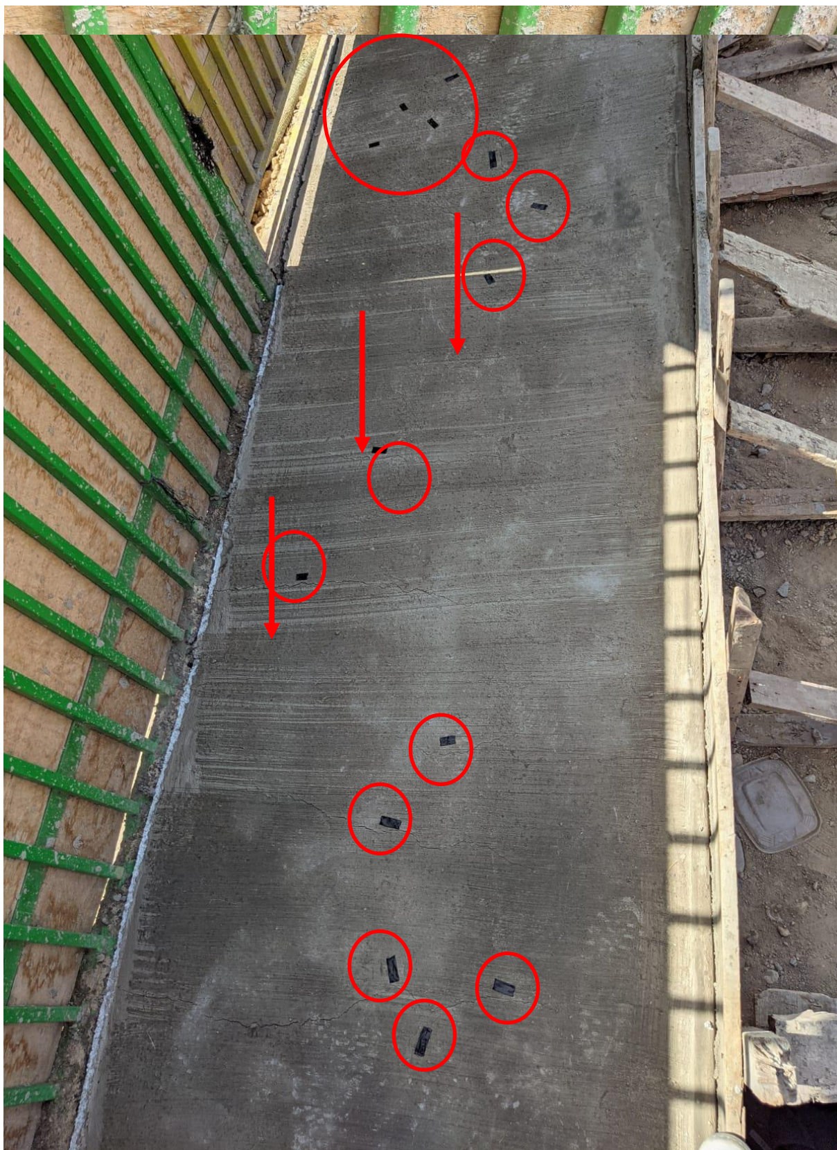
Ilustración 33. Fisuras en Losa + fibra acero Comercial 20 kg/m 3
