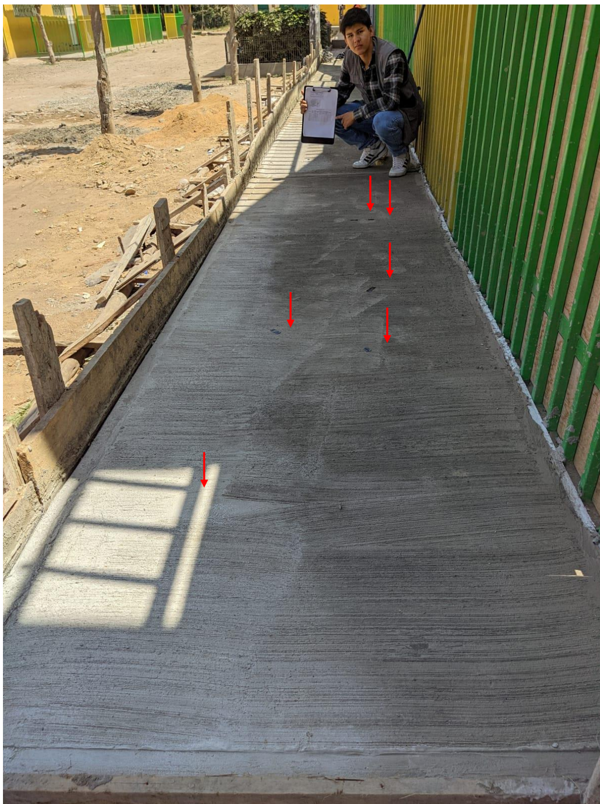
Ilustración 39. Fisuras en Losa + 15 kg/m 3 fibra de alambre
