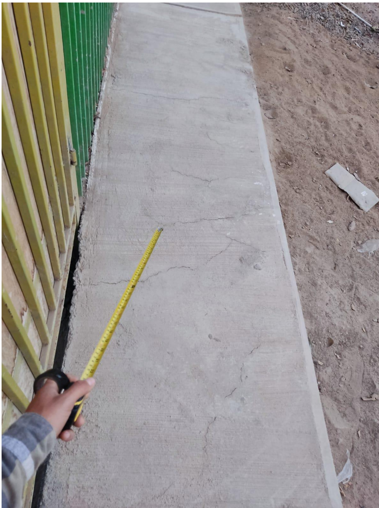
Ilustración 38. Fisuras en Losa + 10 kg/m 3 fibra de alambre
