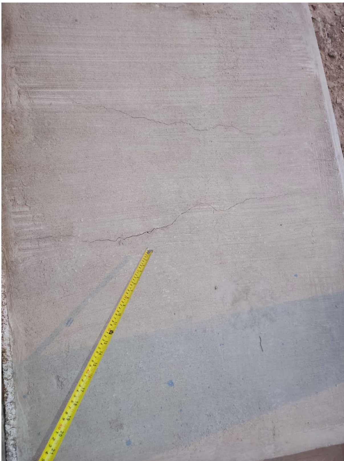
Ilustración 35. Fisuras en Losa + 20 kg/m 3 fibra comercial
