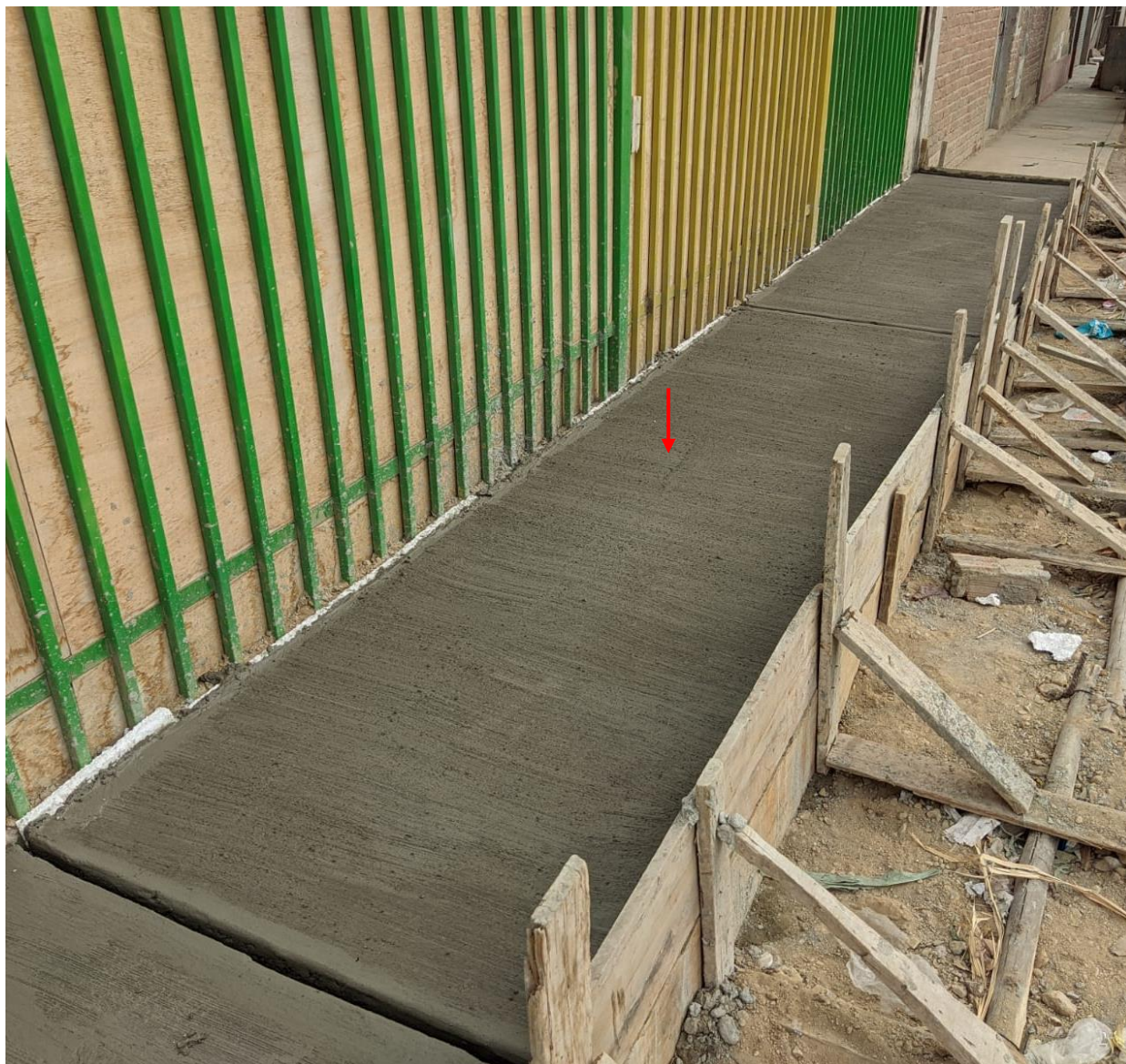
Ilustración 40. Fisuras en Losa + 15 kg/m 3 fibra de alambre
