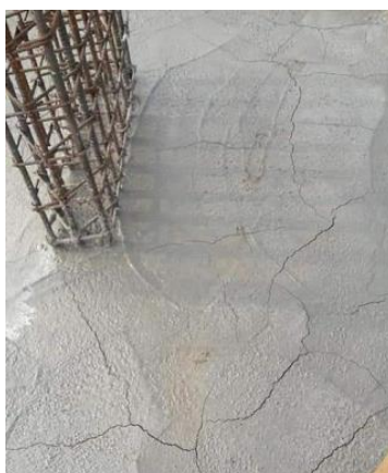
Ilustración 4. Fisuras en losa aligerada por retracción plástica
