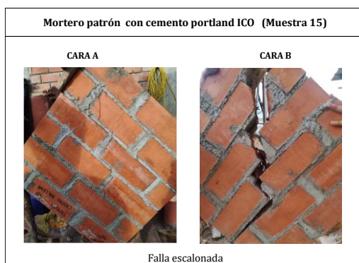
Ilustración 44: Falla del murete N°15 Mortero con cemento portland ICO
