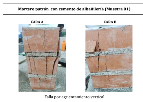
Ilustración 14: Falla de la pila N°01 Mortero patrón con cemento de albañilería
