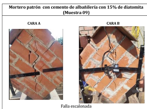
Ilustración 38: Falla N°09 Mortero con 85% cemento de albañilería + 15% de diatomita
