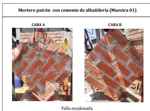
Ilustración 30: Falla del murete N°01 Mortero patrón con cemento de albañilería
