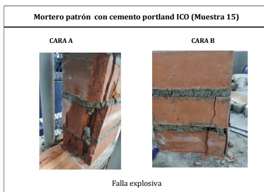
Ilustración 28: Falla de la pila N°15 Mortero con cemento portland tipo ICO
