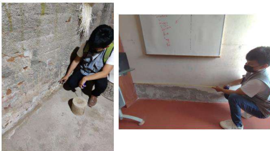
Foto No. 7: Recolección de datos en las áreas de las vigas y columnas afectadas por la eflorescencia
