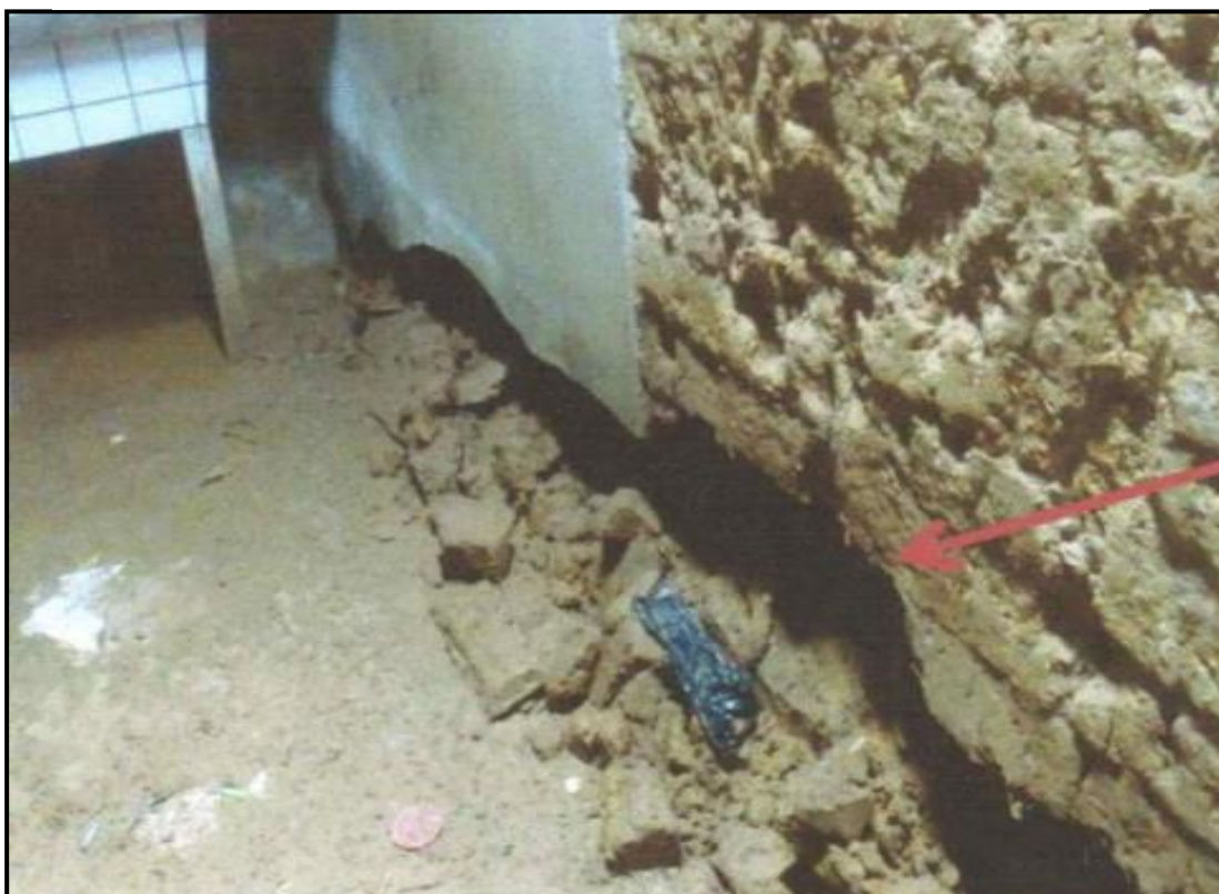
Anexo 23: Pared de vivienda afectada por inundación
