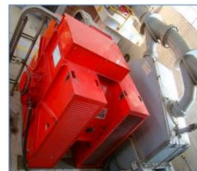
Generador de la Central
