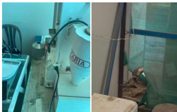
Figura 8 Tomacorriente expuestos - Oficina
