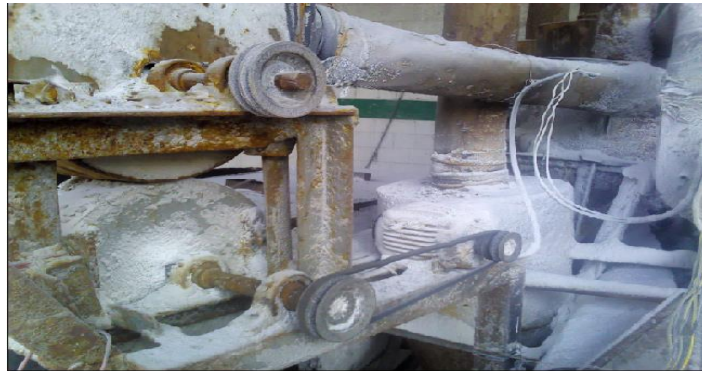
Figura N° 31. Estado de los extractores de polvo de sal.
